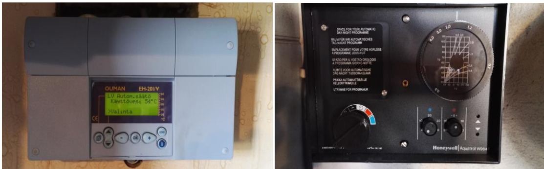
Kuvat 5 ja 6. Lämpimän käyttöveden säädin (Ouman EH-201/V) ja lämmityksen säädin (Honeywell Aquatrol W964F) Nakkilasta.
