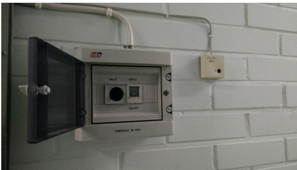
Kuva 2 Tuloilmakoneen ohjaus ja säätö
