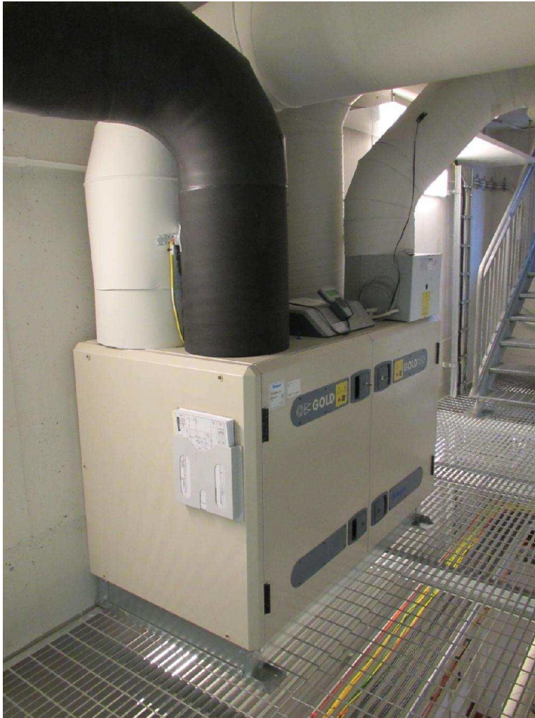
Kuva 14 Tulo- ja poistoilmakone TK1 LTO:lla
