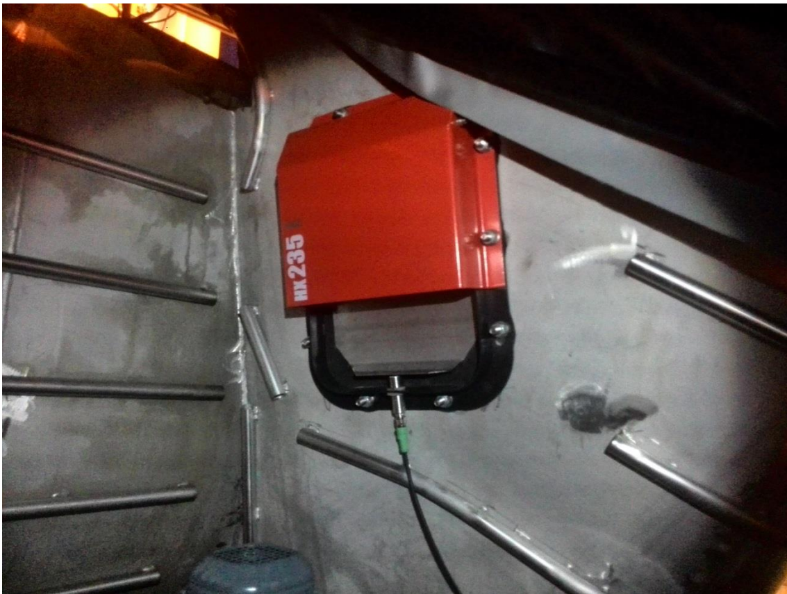
KUVA 16. Liitossuppilon tukosvahti ja induktiivinen rajakytkin
