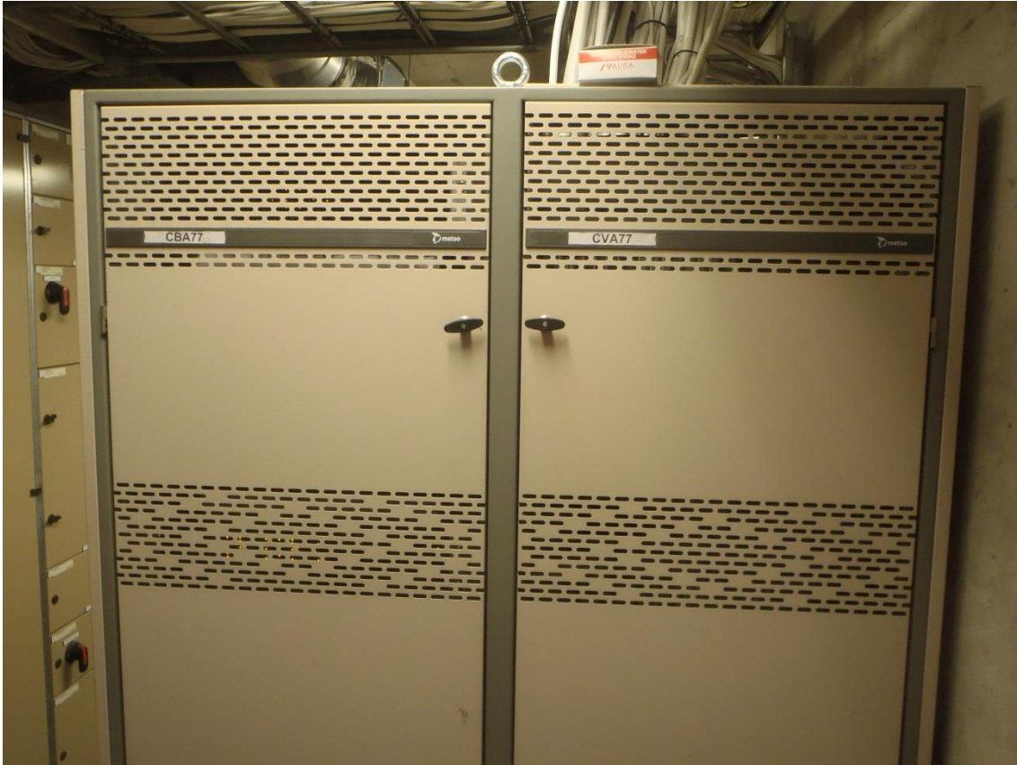
KUVA 9. Metson automaatiojärjestelmän kaapit CVA77/CBA77
