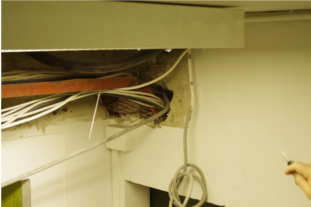
Kuva 3. Osastoivan seinän läpivienti.
