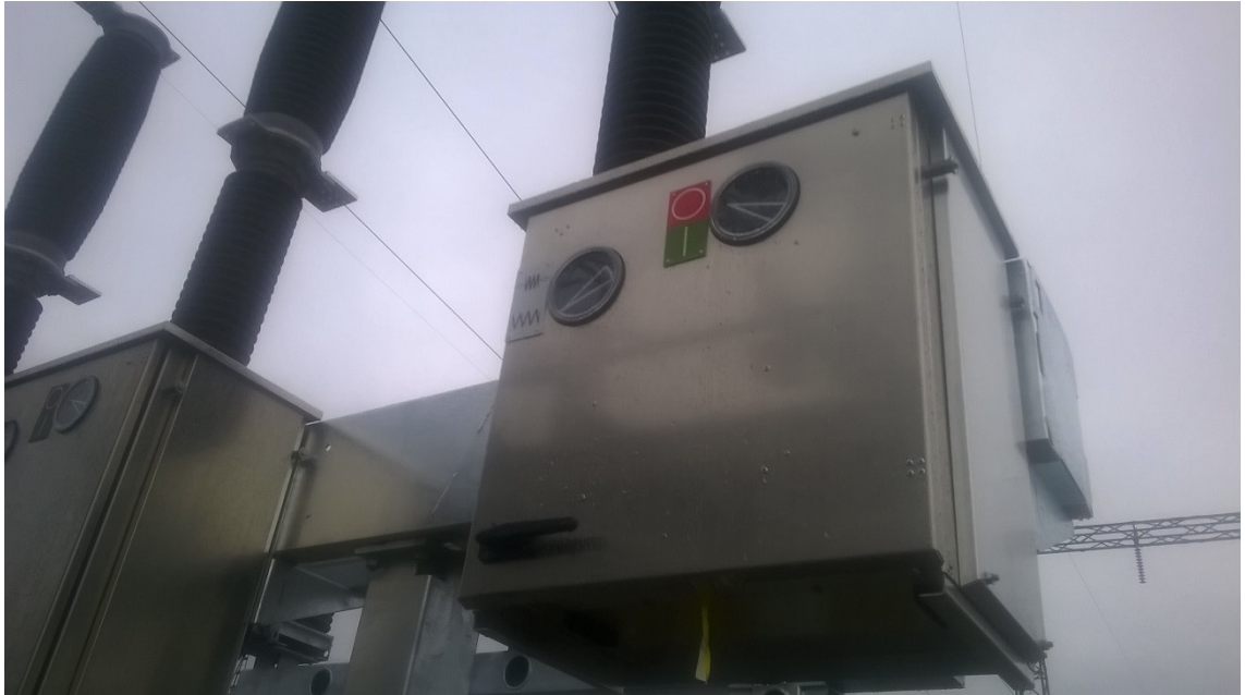
Kuva 7. Katkaisijan tilaosoittimet Petäjaveden 400 kV sähköasemalla
