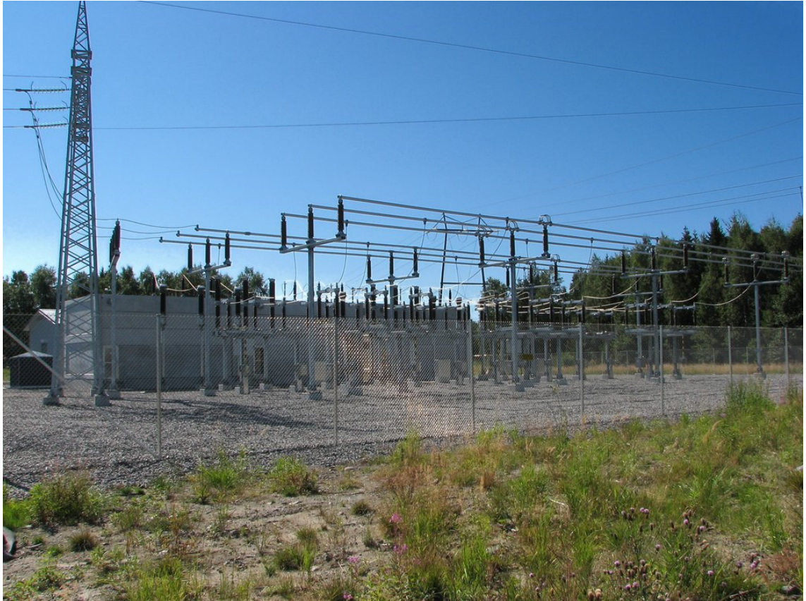
Kuva 3. Kokoojakiskosto 110 kV Junnilan sähköasemalta. (Määttä 2013, kuva 5336)
