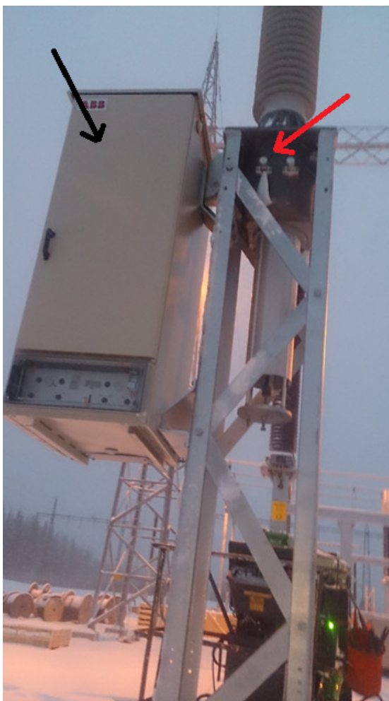
Kuva 33. Ohjainyksikkö ja katkaisijakoneisto asennettuna.
