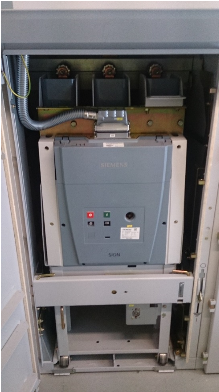
Kuva 9. Siemensin 20 kV ulosvedettävä vaunukatkaisija – tyhjiö väliaineena.
