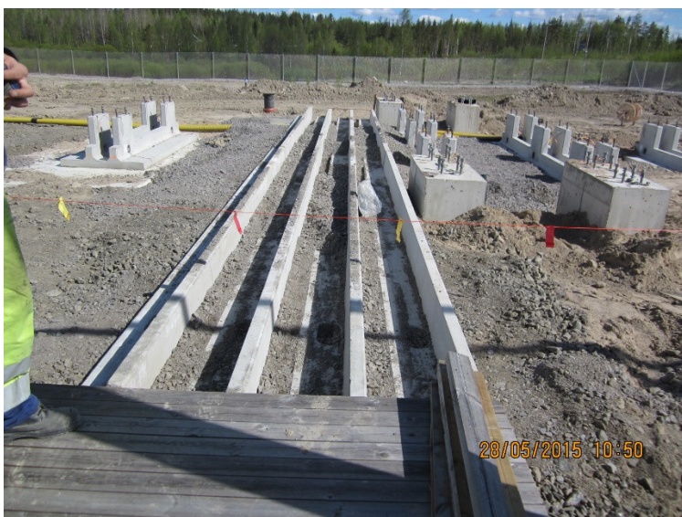
Kuva 25. Kaapelireitti Petäjäveden kytkinkentällä (Empower PN Oy)
