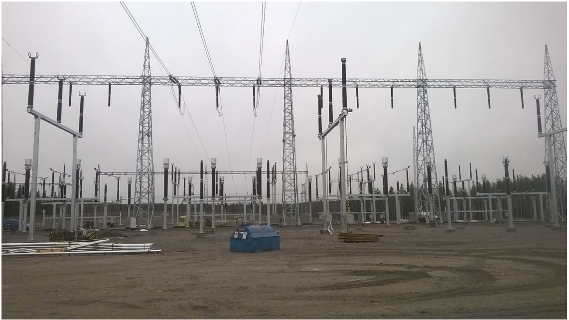
Kuva 4. Petäjäveden valmisteilla oleva 400 kV kytkinkenttä – edessä kokoojakiskosto ilman putkia sekä kiskostoon tulevat putket odottamassa asentamista.
