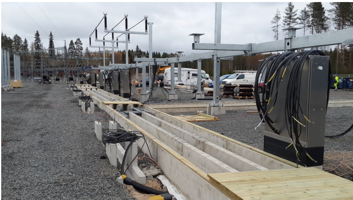
Kuva 21. Mäntän uusi kytkinkenttä ja sen takana näkyvä vanha kytkinkenttä (Empower PN Oy)
