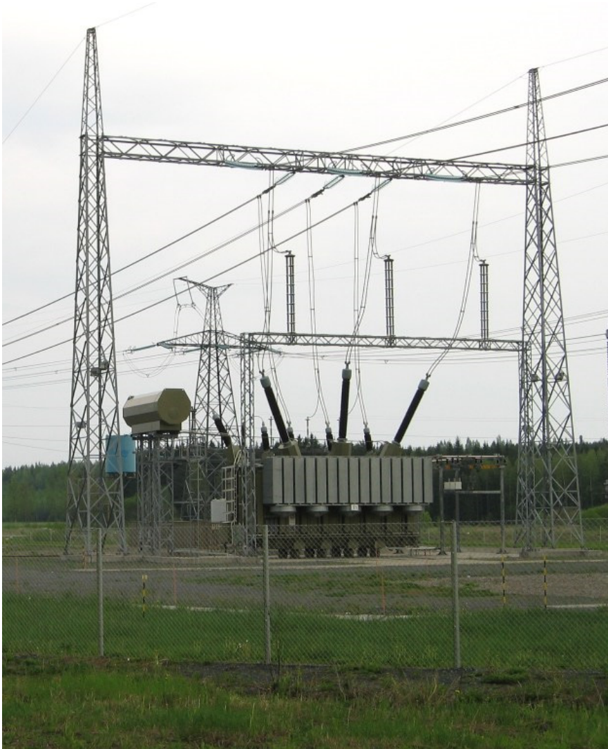
Kuva 6. Forssan sähköaseman 400/110 kV muuntaja (Määttä 2013, kuva 348)
