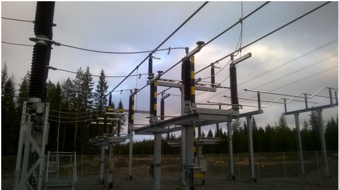
Kuva 10. 110 kV erotin luotettavasti auki sekä muuntajan puoleinen linja maadoitettuna. Takana näkyy vastaavanlainen erotin kiinni. Kuva on otettu eräältä sähköasemalta Kalajoella.
