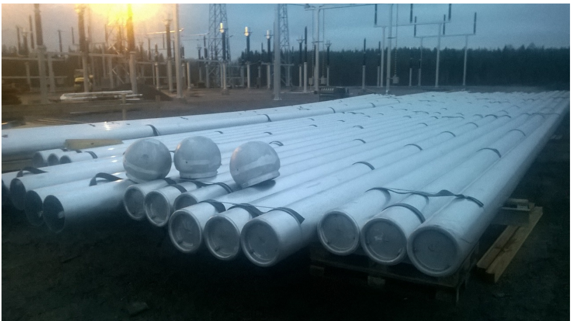
Kuva 5. Kokoojakiskostoon tulevat alumiiniputket Petäjäveden 400 kV kytkinkentälle.
