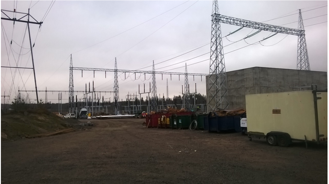
Kuva 22. Petäjäveden kytkinkenttä ja muuntajabunkkeri käytössä olevien voimalinjojen alapuolella.
