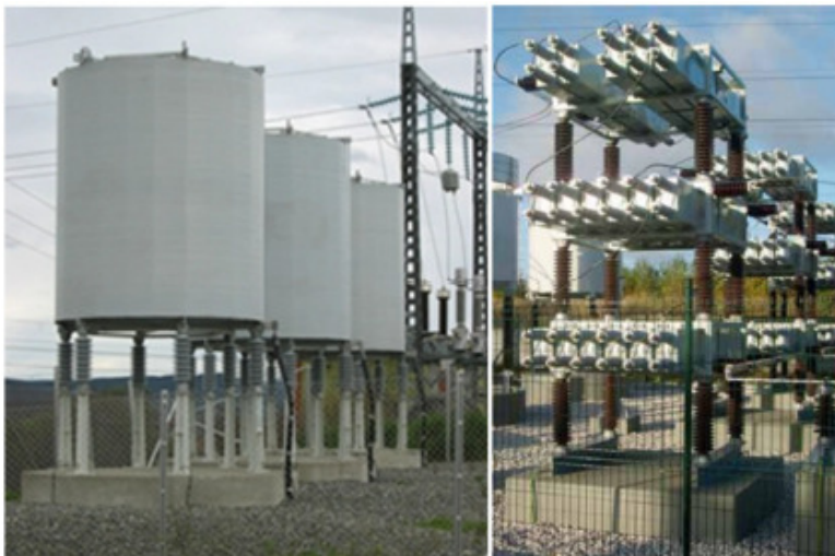
Kuva 14. Kompensointilaitteistoja: Reaktorit vasemmalla ja kondensaattorit oikealla. (Hautaniemi Olli, 38)
