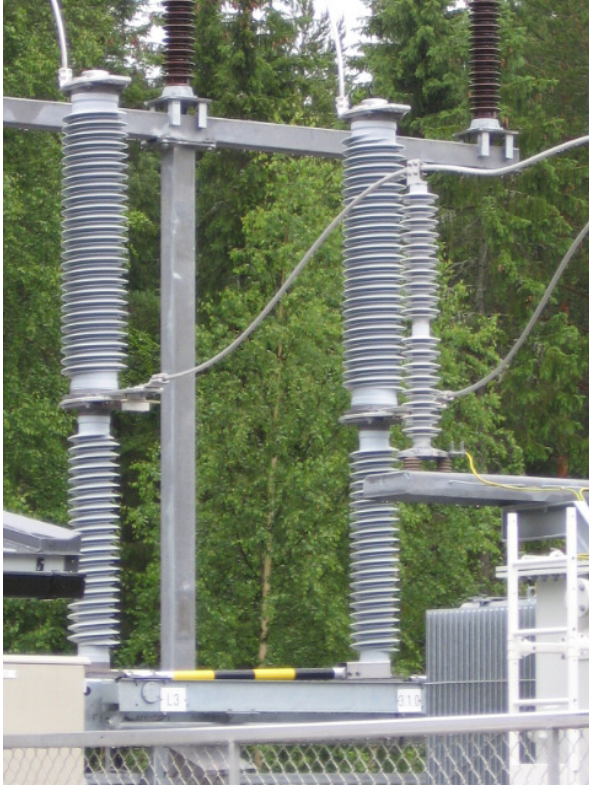
Kuva 8. 110 kV SF6 -katkaisija Halttulan sähköasemalta. (Määttä 2013, kuva 2518)
