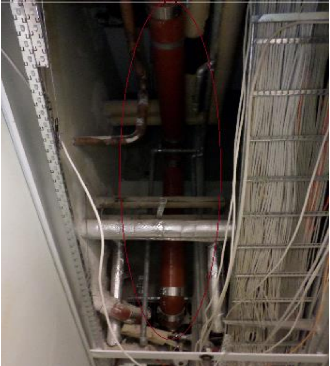
Kuva 18: Viemäri linja, josta puhditusrassi ei pääsyt läpi
