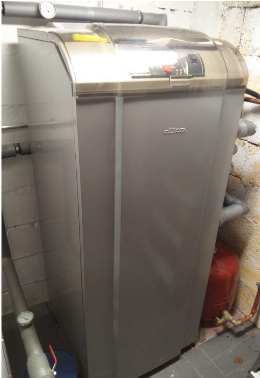
KUVA 10. Maalämpöpumppu Oilon Geopro GT 11 asennettuna lämmönjakotiloihin
