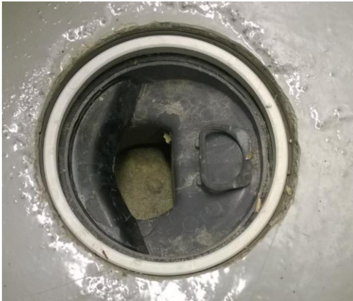
Kuva 30. IV-konehuoneen viemäri vuotavalla putken liitännällä
