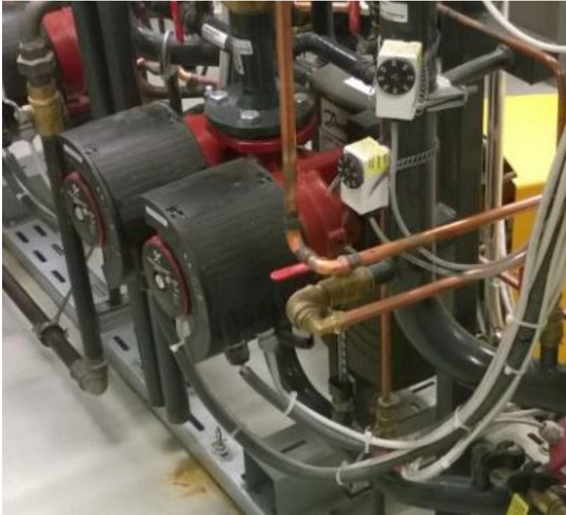
Kuva 14. Kaukolämpökeskuksen vesipumput taajuusmuuttajineen
