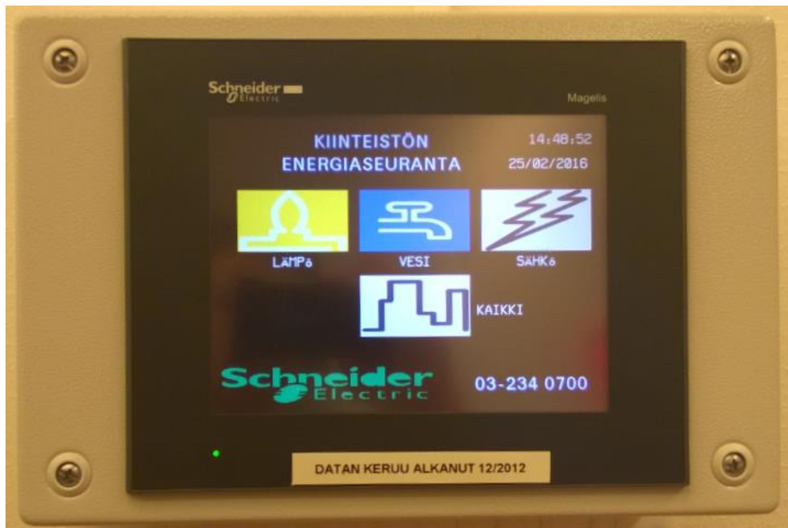
Kuva 32. Käytävälle sijoitettu energiaseuranta-paneeli
