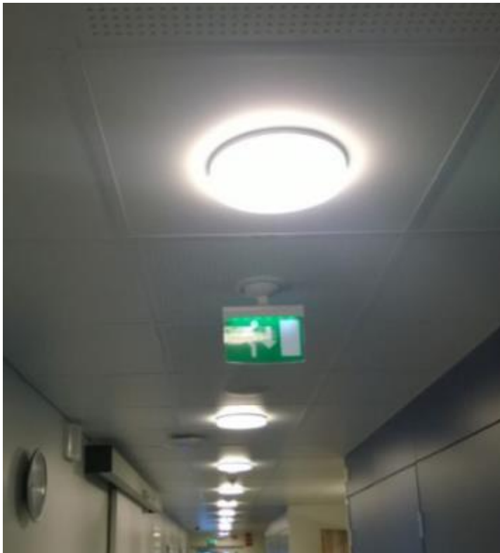
Kuva 28. Käytävien valaistus on ohjattavissa ”yö”- ja ”päivä”-tilaan
