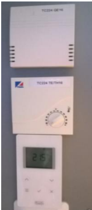
Kuva 37. Hiilidioksidianturi, alkuperäinen huonesäädin sekä lisätty langaton säädin
