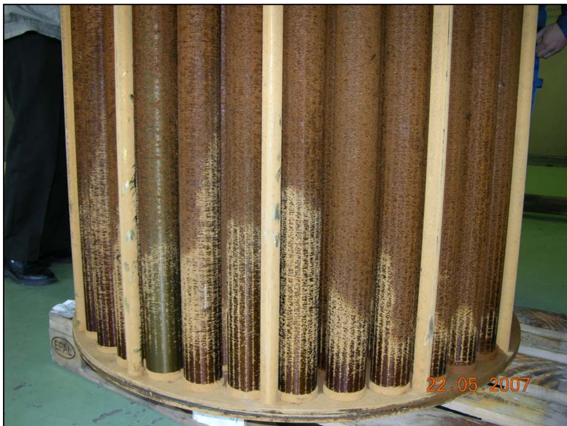
Kuva 4. Vaurioitunut suodatin keväältä 2007.
