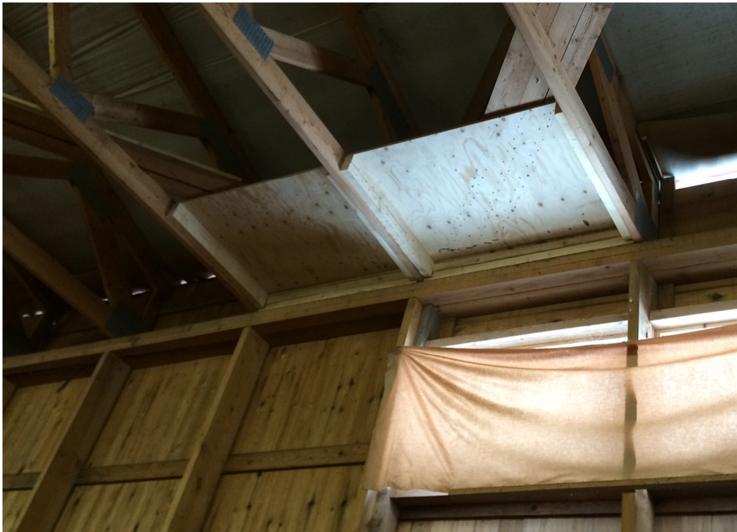
KUVA 34. Korjatut vinositeet, seinän kolmannespisteessä
