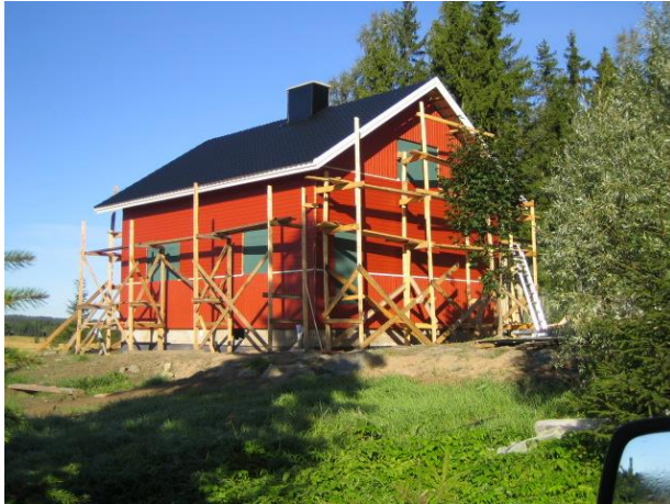
Kuva 10 Ulkoverhous valmis. Ikkuna- ja oviaukot vielä ummessa. Vaakalistat näkyvät paneelien suunnanmuutoskohdissa valkoisina.
