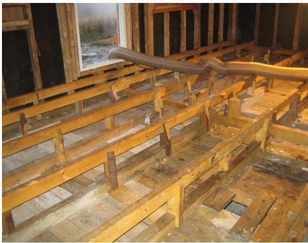
Kuva 5. Alkuperäinen, yhdensuuntainen koolaus.
