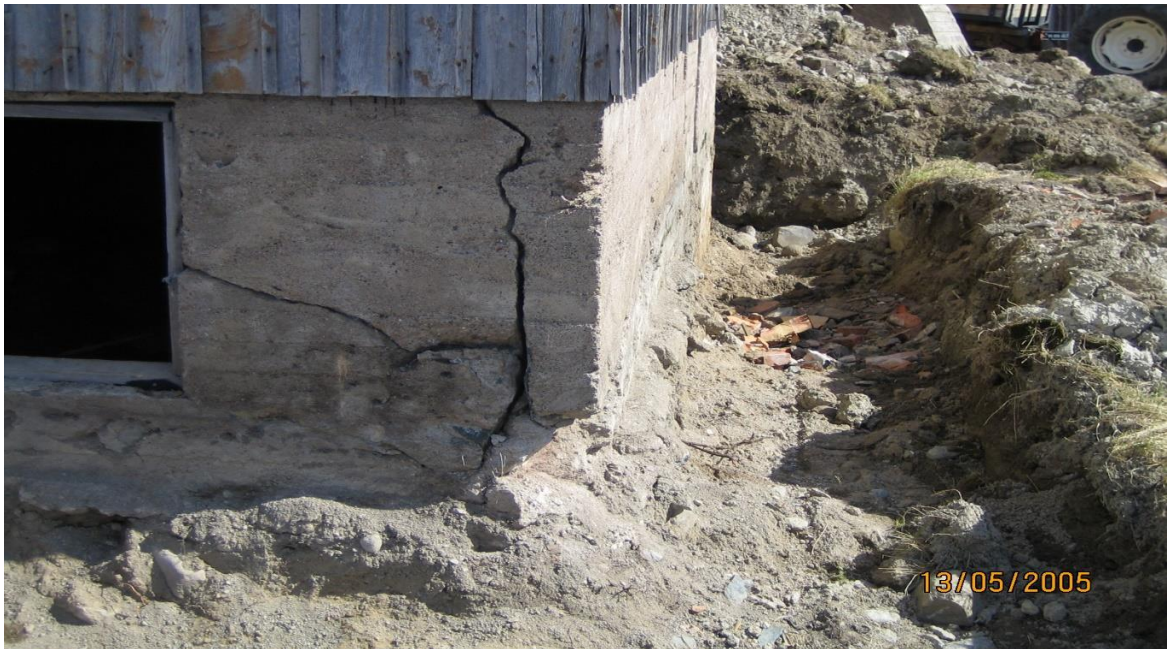
Kuva 2. Murtunut sokkeli. Kuvassa näkyy myös yksi rossipohjan tuuletusaukoista.
