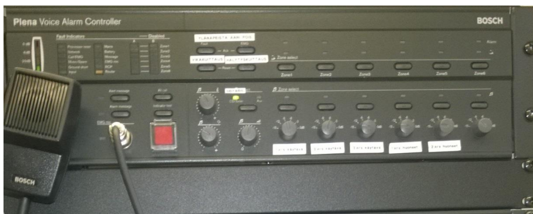
KUVA 19 Plena ohjainyksikkö (Pulkkinen 2014-07-03.)
