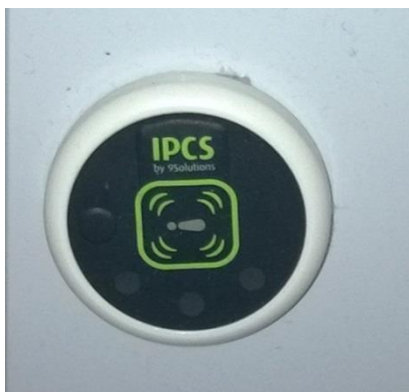
KUVA 18 9Solutions-hälytyspainike, eli tagi (Pulkkinen 2016-02-09.)
