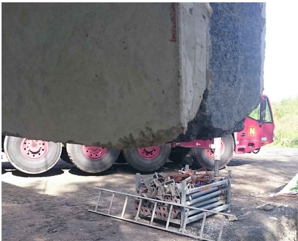
Kuva 13. Vaurioituneen elementin julkisivupinnasta on rikkoutunut kulma. Taustalla näkyy elementtien nostoihin käytettävä ajoneuvonosturi. (Oksman 2015)
