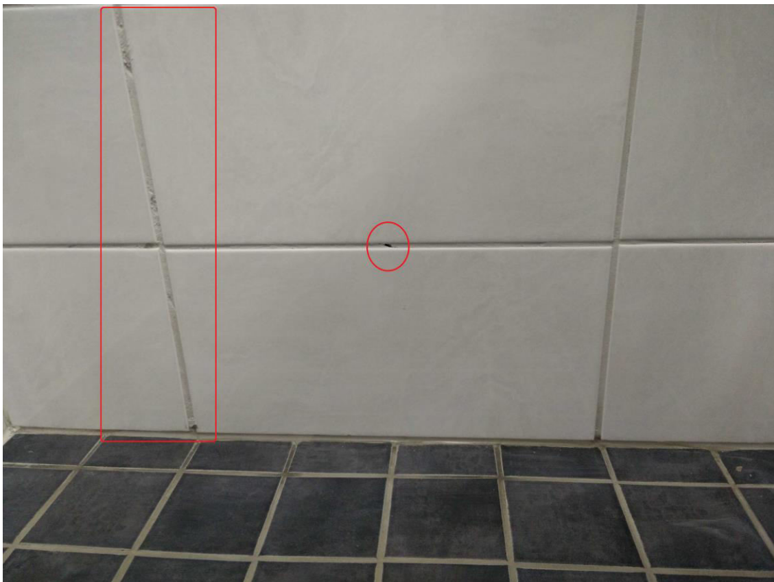
Kuva 15. Vasemmalla rakenteen 6 huokoiset saumat ja keskellä rakenteiden 6 ja 7 saumassa oleva reikä.
