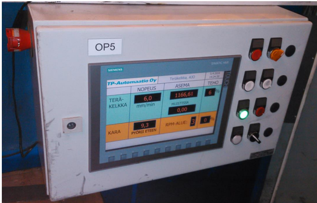
KUVA 8. Uusi valvomon ohjauskotelo käytössä
