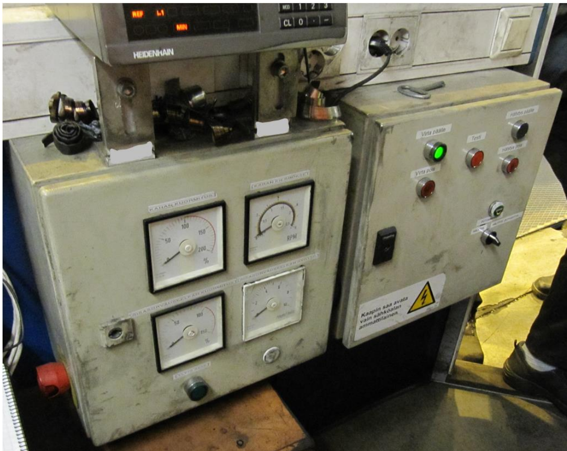
KUVA 2. Vanhat valvomon ohjauskotelot
