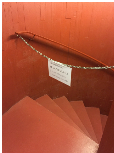
KUVA 7. Portaasta puuttuu kontrastit, minkä takia se on vaarallinen.
