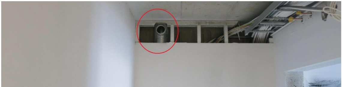
KUVA 29. Poistokanava käytävän päässä tekniikkakuilussa.
