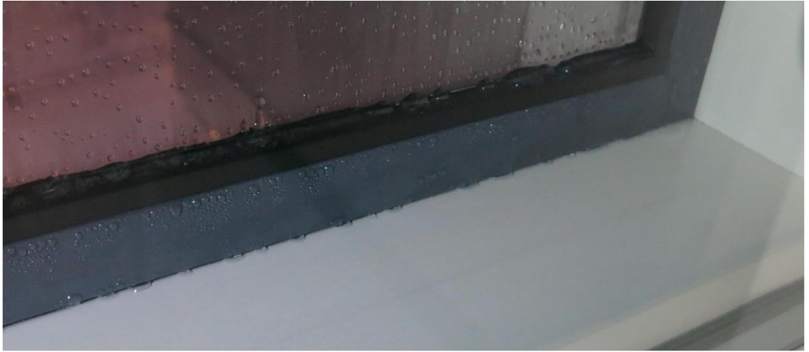
KUVA 4. Ikkunarakenteeseen on tiivistynyt työmaalla vettä. Lopullinen ilmanvaihtojärjestelmä ei ollut käytössä kuvanottamishetkellä.
