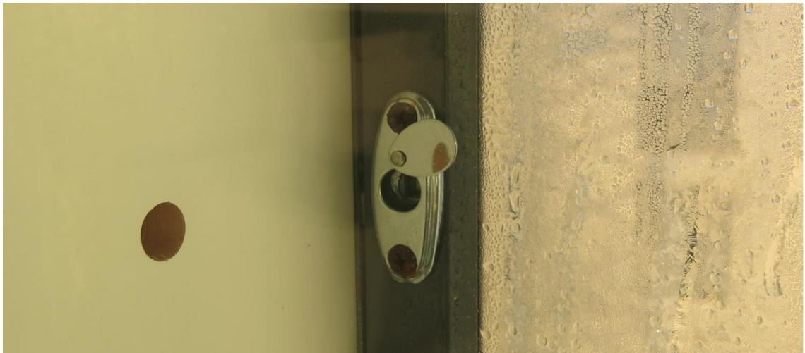
KUVA 7. Liiallinen ilmankosteus on tiivistynyt ikkunarakenteen sisälle ja sen seurauksena ylimääräinen ilmankosteus on aiheuttanut korroosiovaurioita ikkunahelojen kiinnikkeille.
