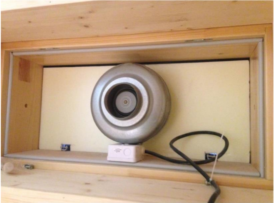
KUVA 22. Kuvassa on Asunto Oy Sipoon Tuhkimon työmaalla käytetty pistotulppaliitännällä varustettu kanavapuhallin. Kuvassa näkyy puhaltimen sijoitus huoneistosaunan ikkunaan.
