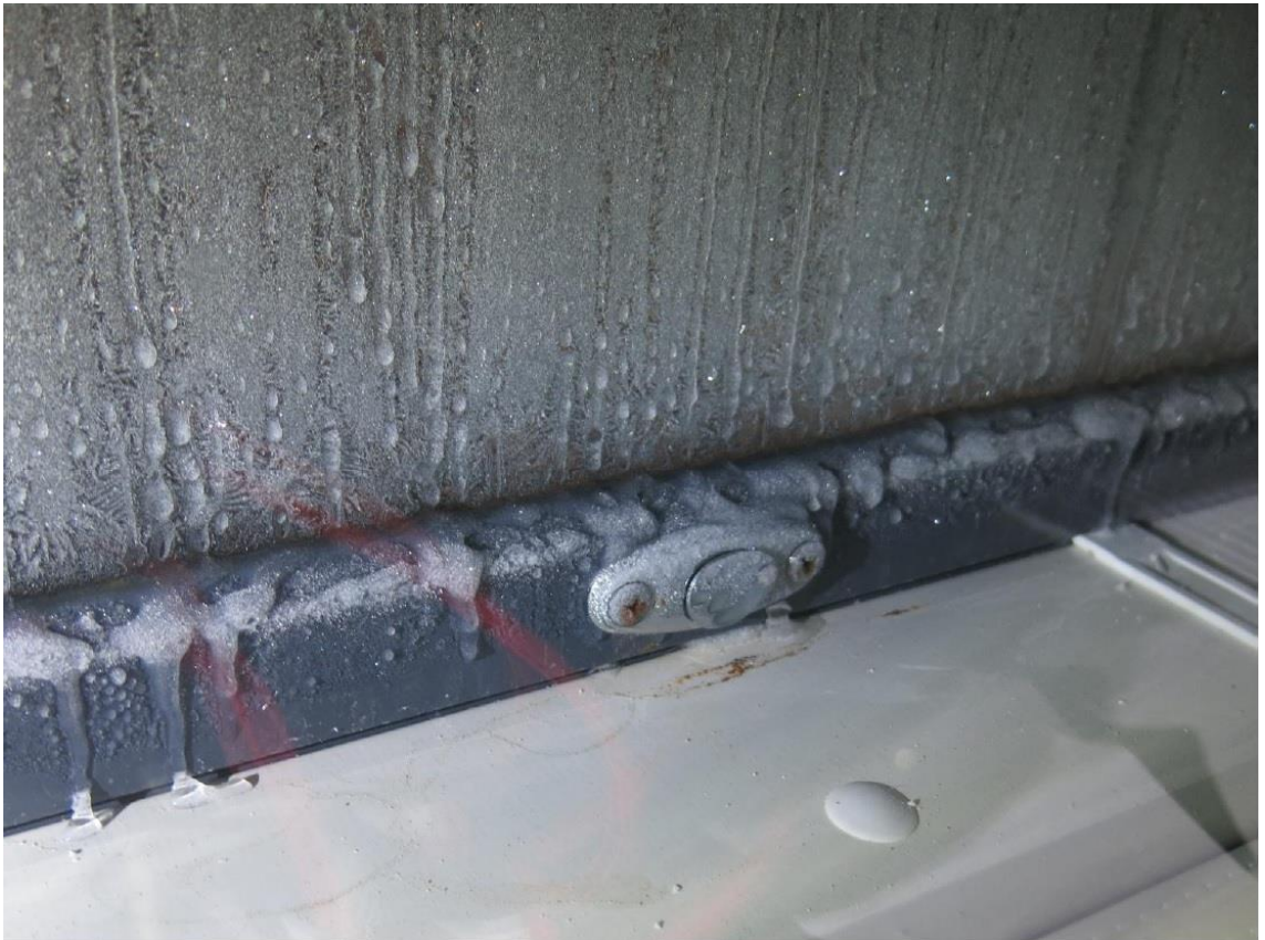
KUVA 5. Ikkunan ulkopuitteen lasin sisäpintaan on jäätynyt kondensoitunutta vettä. Laadun kannalta asia on riski, kun jää sulaa jossain vaiheessa vedeksi.
