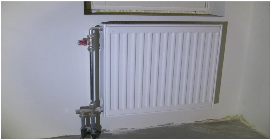
KUVA 27. Kuvassa on radiaattori, josta on jo poistettu tehtaan muovisuojat. Huoneistossa on tasoitus- ja maalaustyöt tehty ja silloin lopullista lämmitysjärjestelmää voidaan hyödyntää huoneiston lämmityksen apuna.
