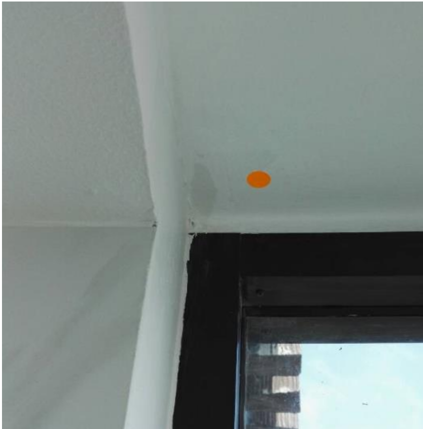
Kuva 4. Väritarralla merkitty vika maalipinnassa. (Kuva: livo Levaniemi)
