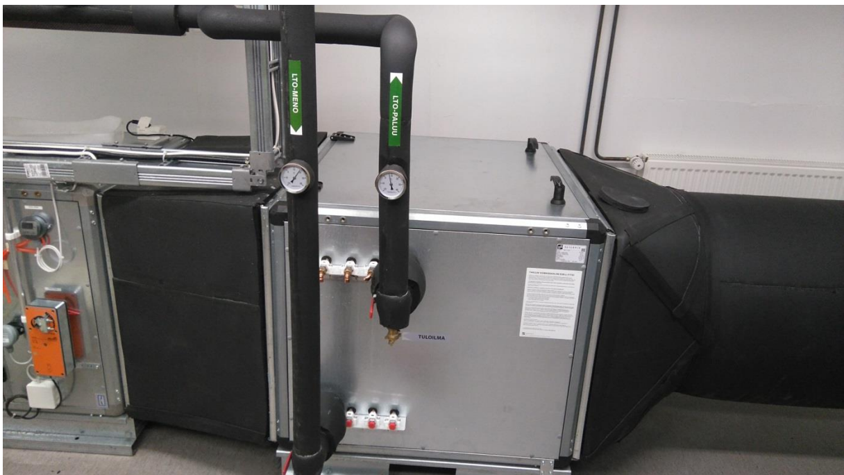
KUVA 7. Tuloilmakoneessa (TK1) oleva neulaputkilämmönsiirrin
