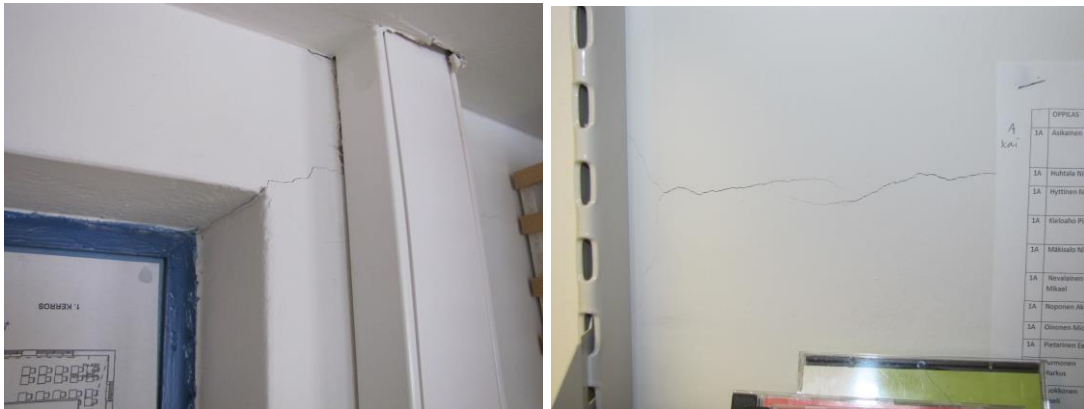
Kuva 70 ja Kuva 71. Halkeamat seinissä, huone 117
