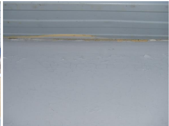
Kuva 25. Maali hilseilee kourun alla
