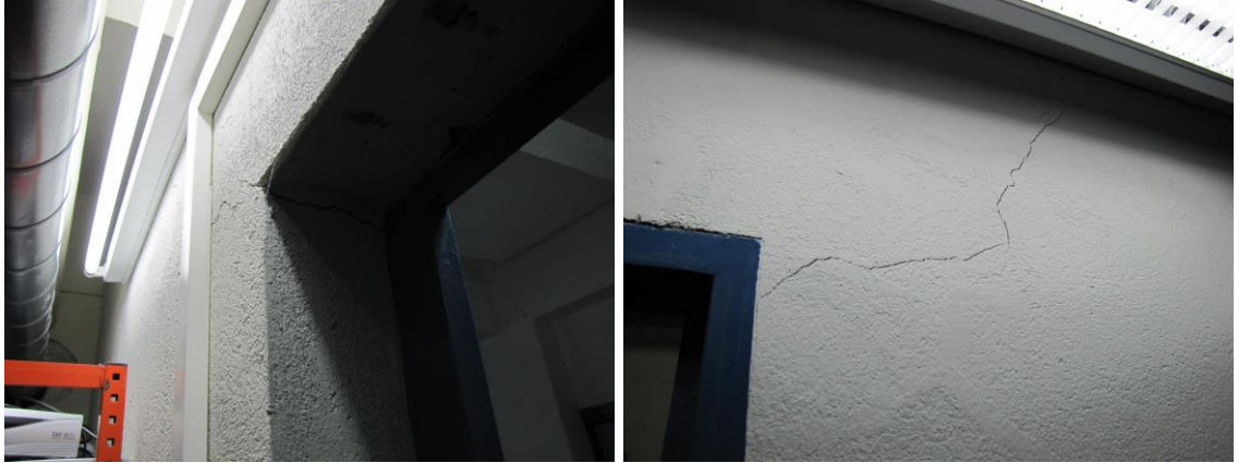
Kuvat 117...120. Halkeama huoneessa 021
