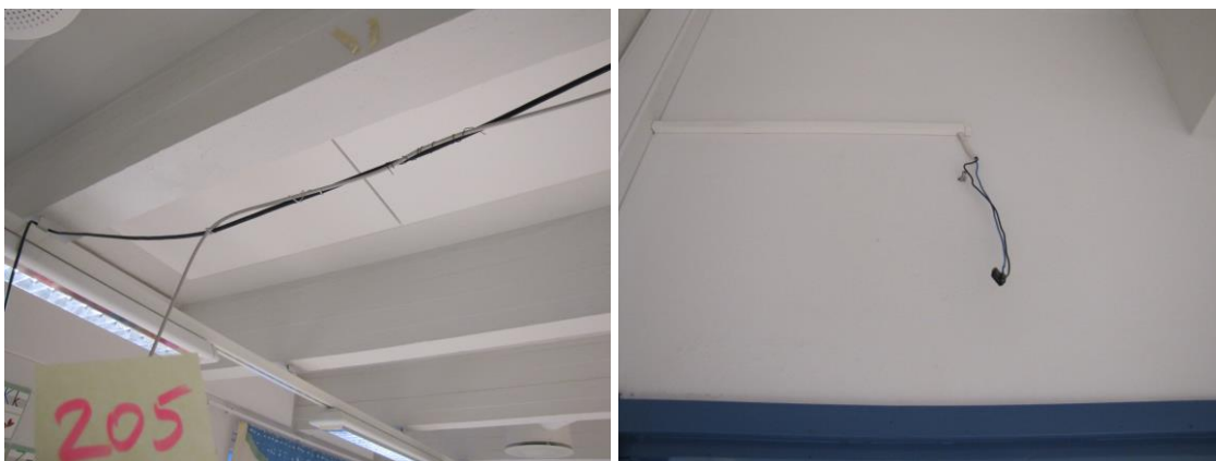
Kuva 52 ja Kuva 53. Roikkuvat sähköjohdot
