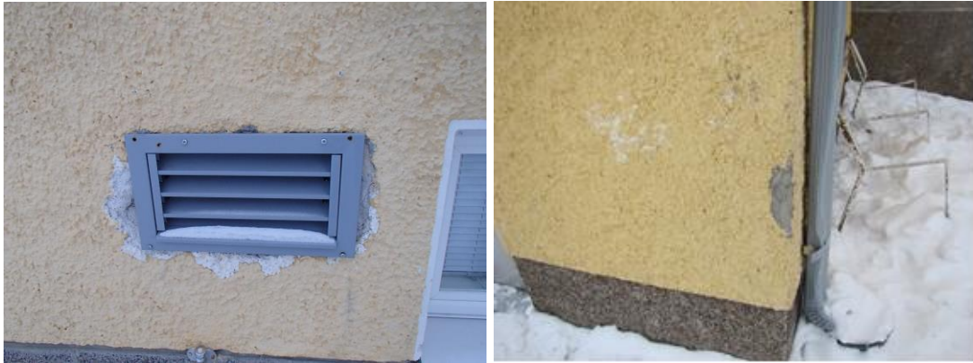
Kuva 9 ja Kuva 10. Kolhuja ulkoseinässä
