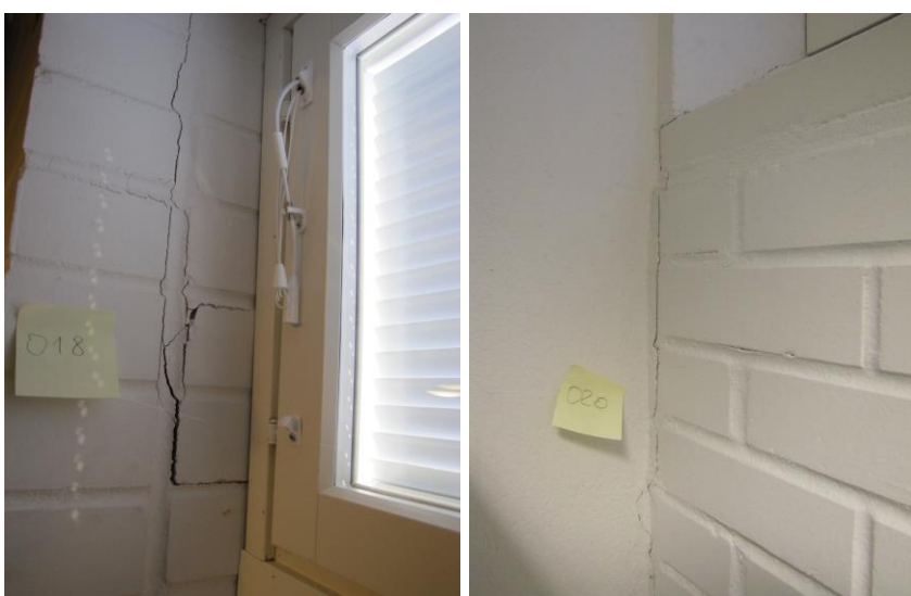
Kuva 60 ja Kuva 61. Halkeamat seinissä
