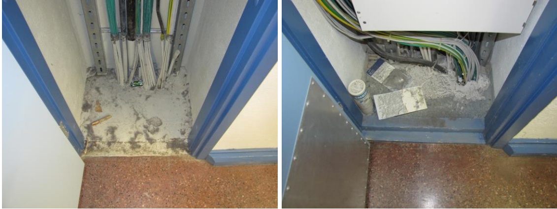
Kuva 125 ja Kuva 126. Pölyä jakokeskuskaapeissa
