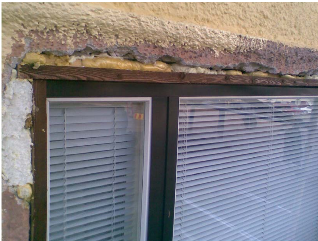
Kuva 1, Ikkunaremontin yhteydessä lohkeillutta rappausta
