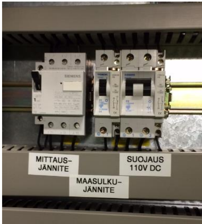
Kuva 18 Kennossa olevat sulakkeet (Kuva: Niko-Ville Ylioja)
