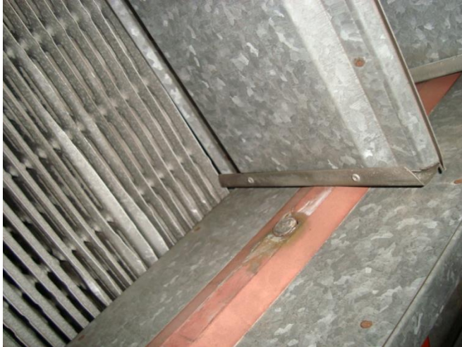
Kuva 4. Levylämmönsiirtimen säätöpellistön säleen katkennut akseli.
