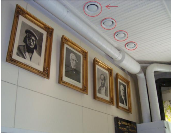
Kuva 8. Avoinna olevat, käytöstä poistetut poistoilmaventtiilit.
