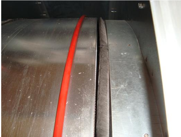
Kuva 5. Pyörivän lämmönsiirtimen roottorin loppuun kulunut harjatiiviste.
