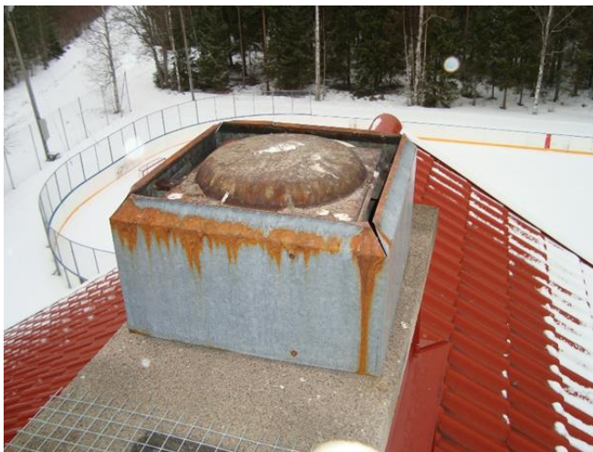
Kuva 3. Teknisen käyttöikänsä ohittanut huippuimuri vuodelta 1977.
