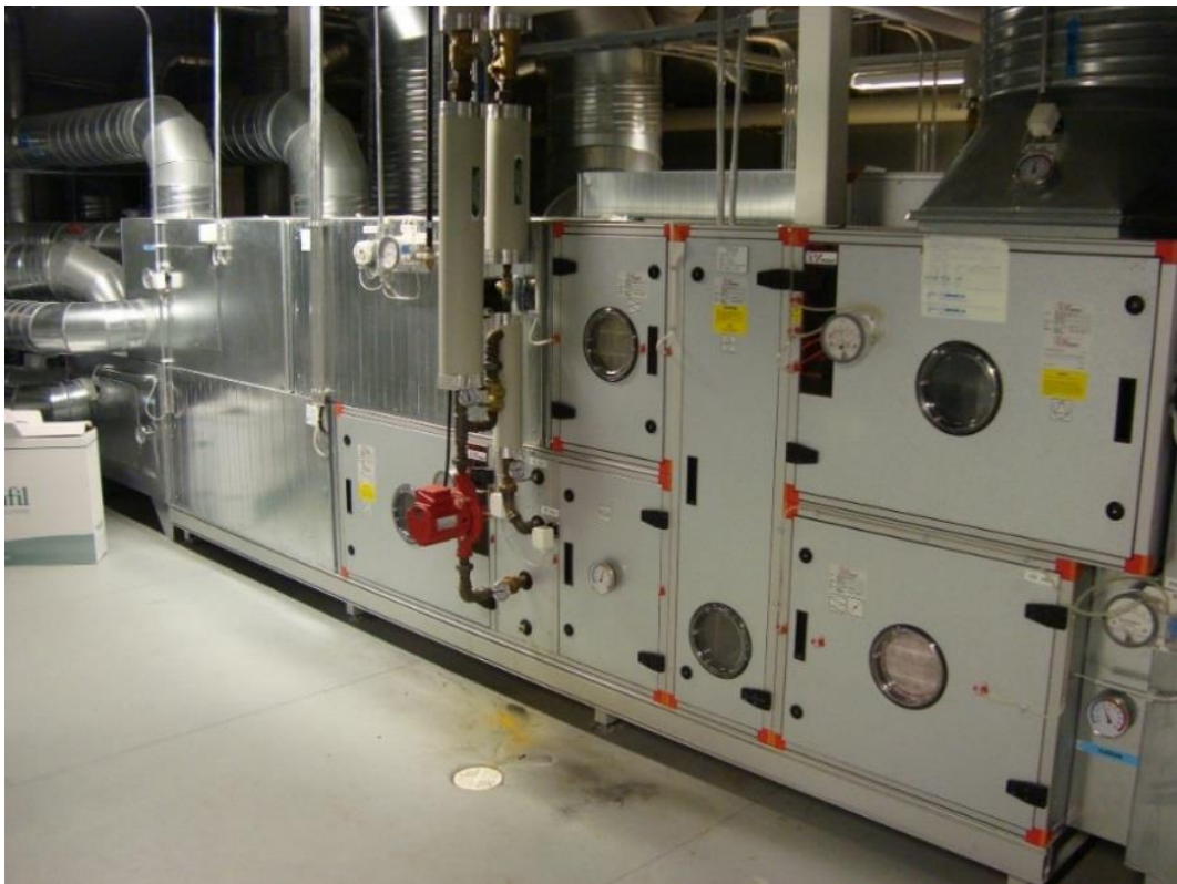
Kuva 1. Yleiskuva erään kohteen tulo- ja poistoilmanvaihtokoneesta.
