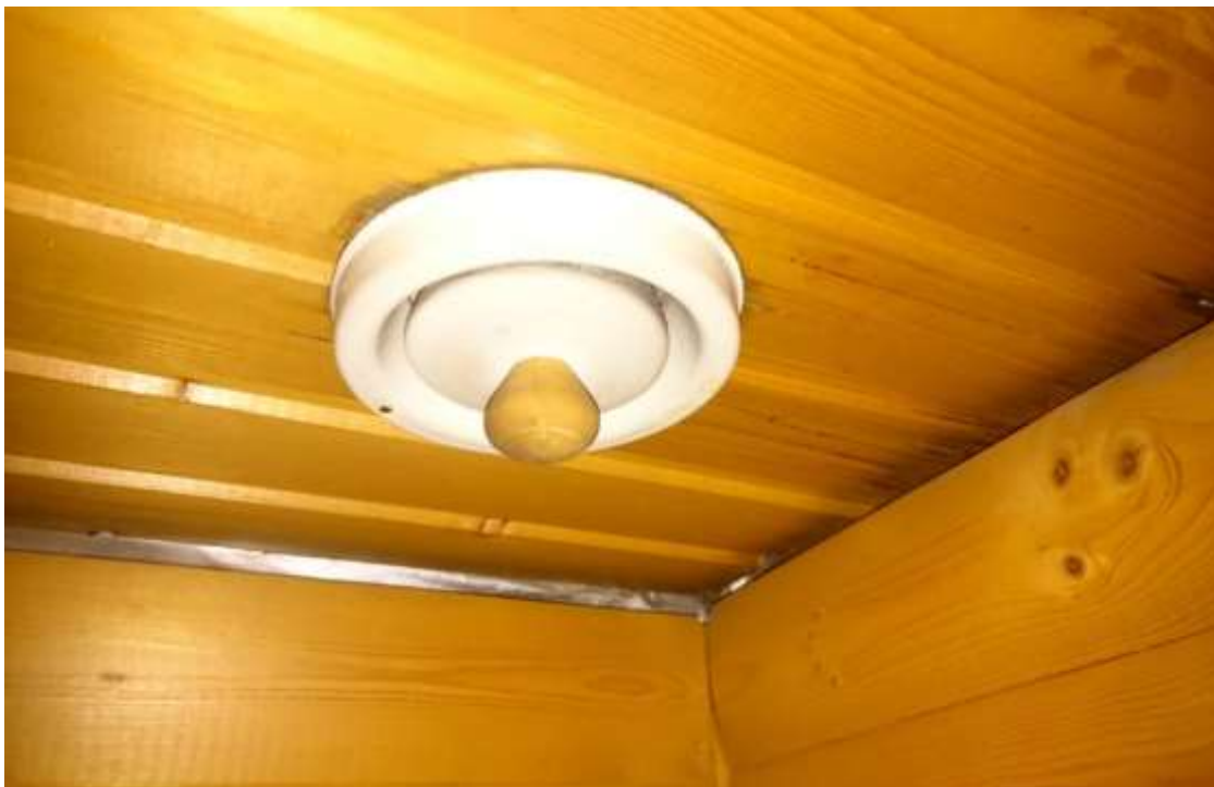
Kuva 13. Saunan poistoilmaventtiilin oikealla puolella havaittavissa kosteutta, joka on peräisin yläpohjan puolelta tulleesta vuotovedestä.
