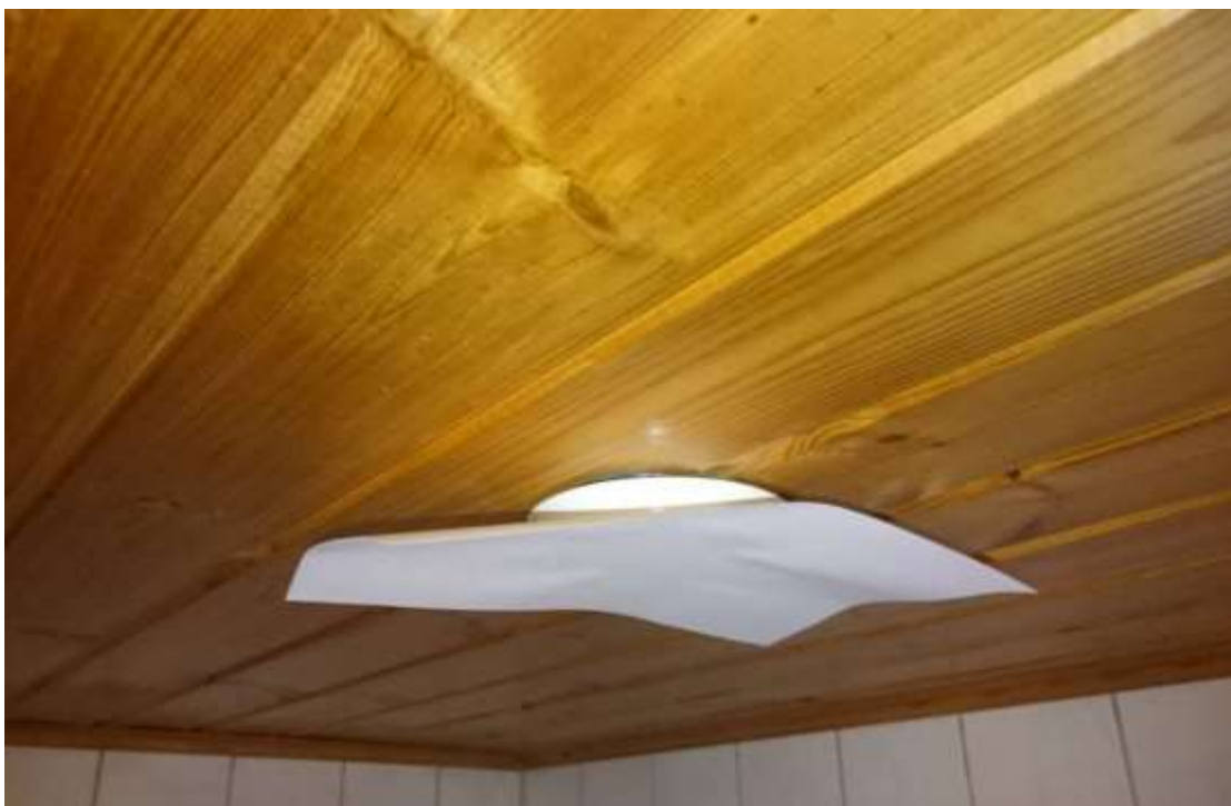
Kuva 19. Ilmanpoisto on toimiva, sillä paperi jää roikkumaan korvausilmaventtiin jo poistoilmaimurin 1. asennossa.
