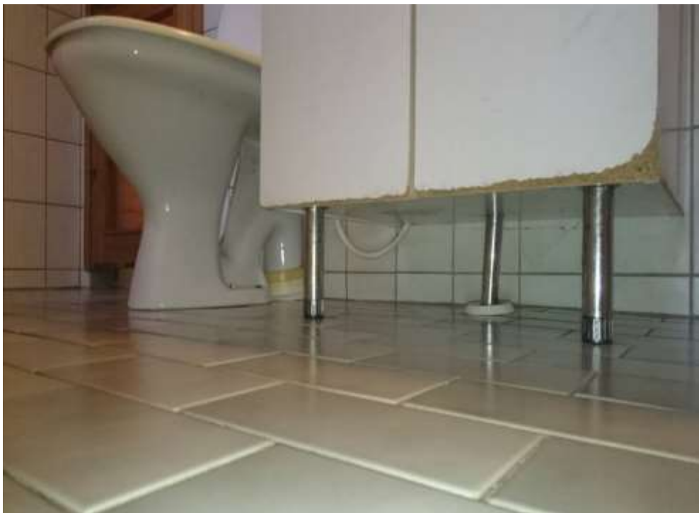
Kuva 9. Allaskaapin ovet ovat kuluneet reunoistaan selvästi.
