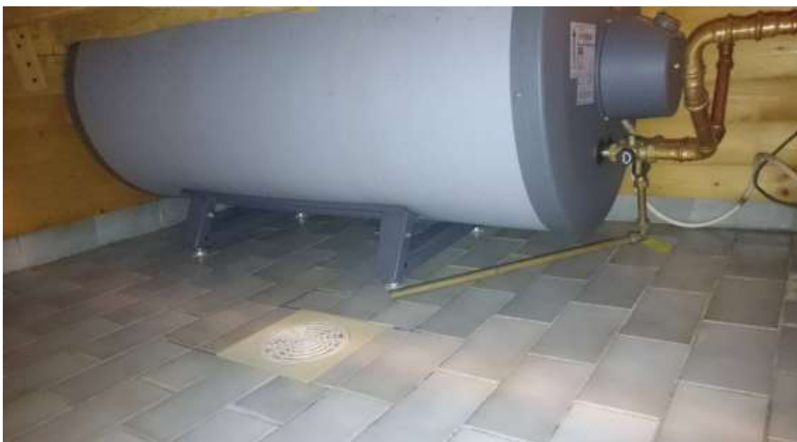
Kuva 24. Lauteiden alla sijaitsee lämminvesivaraaja.
