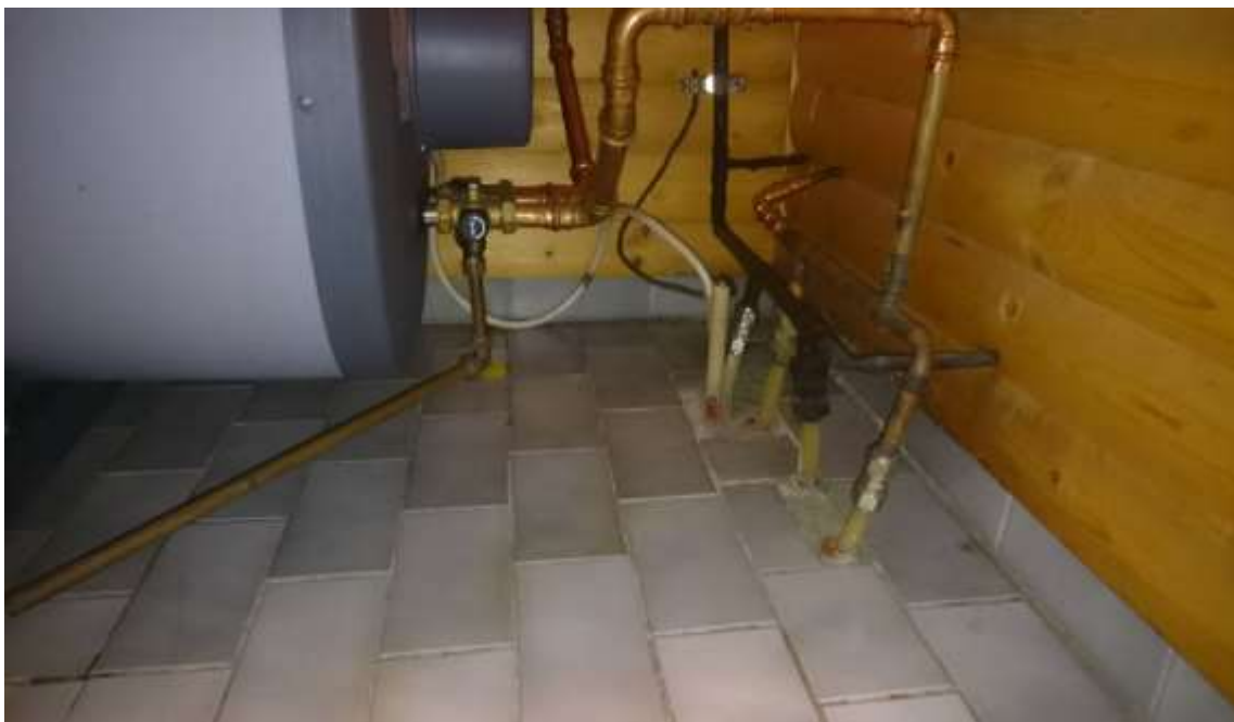
Kuva 18. Lämminvesivaraajan luona ovat myös vesiputket, jotka nousevat suoraan lattiasta, joka on nykymääräysten vastainen ratkaisu.
