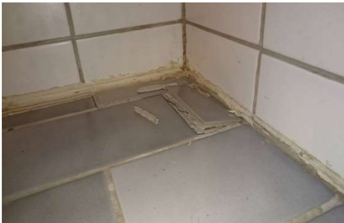
Kuva 2. Lattialaatoitus on päässyt irtoilemaan alustastaan
