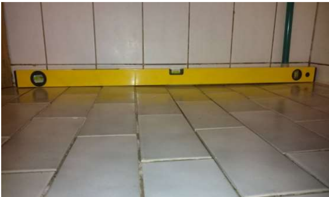
Kuva 4. Suihkun alapuolella lattia on epätasainen.
