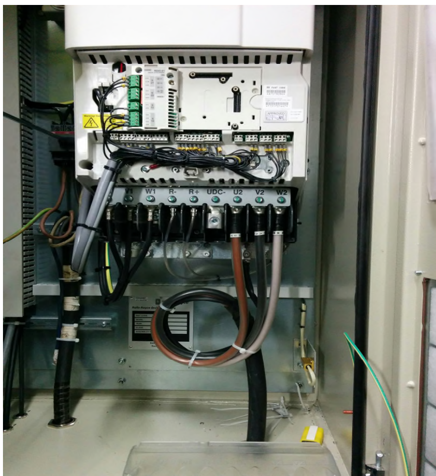
Kuva 19. Moottorin syöttökaapeli oikealla ristiinkytketään.(Ville Höyden)
