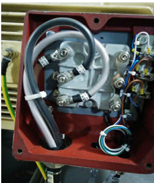
Kuva 14. Hyvin tehdyt kytkennät
