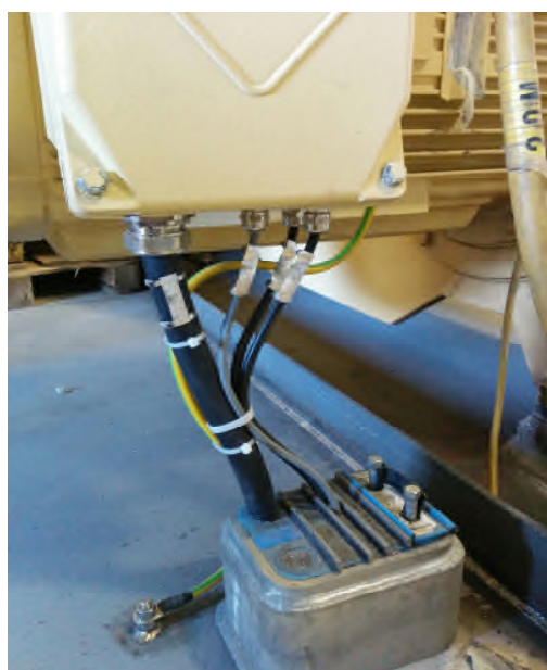
Kuva 15. Läpiviennit ja maadoitus
