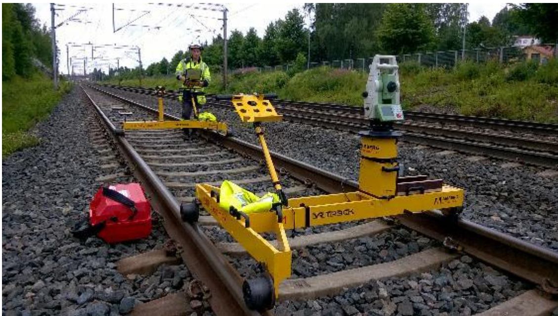
Kuva 16. VR trolleymittausta kahdella vaunulla. (Kuva: Mia Leppänen)
