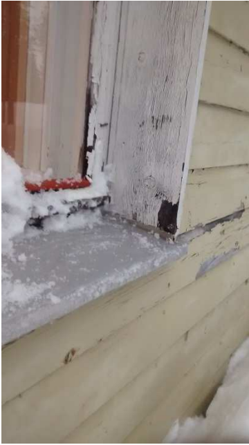
KUVA 6. Ikkunoiden vesipellit ovat liian loivassa kulmassa
