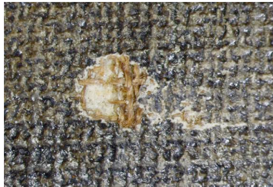
Kuva 12. Pienet pohjustuksen puutokset reikien ympärillä, 10x suurennos
