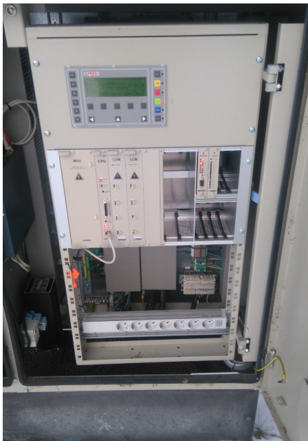
Kuva 1. Liikennevalokaapissa sijaitseva EC-2-ohjauskojeisto
