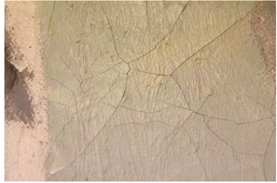
Kuva 20. Maalipinnan ikääntymisestä johtuvia krakelyyriä.
