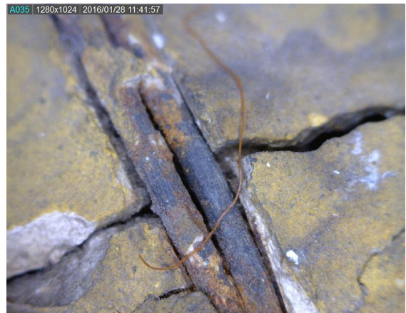
Kuva 11. Metallilankatukia ja niiden alla oleva halkeama.
