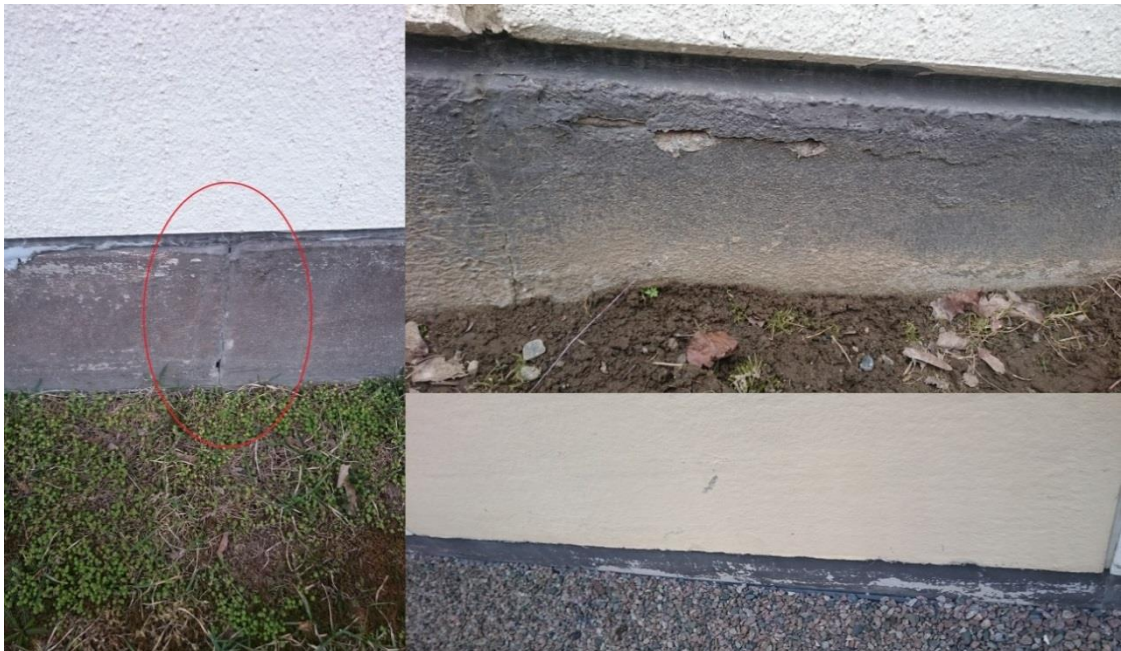
Kuva 5. Sokkelin halkeama ja korroosion aiheuttamaa halkeilua AB-talon koillissivulla sekä sokkelin maalin hilseilyä CD-talon päädysssä.
