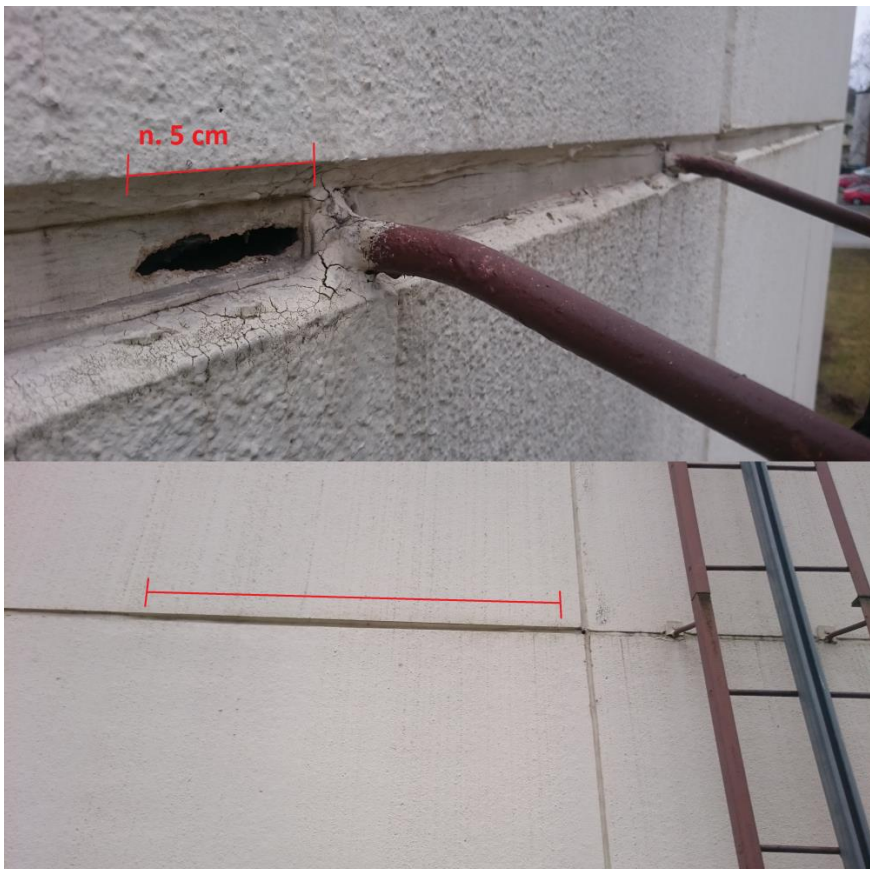
Kuva 8. Leveä elementtisauma syvällä CD-talon koillispäädystä ja sauman reikä tikkaiden kiinnityksen kohdalta AB-talon luoteispäädystä
