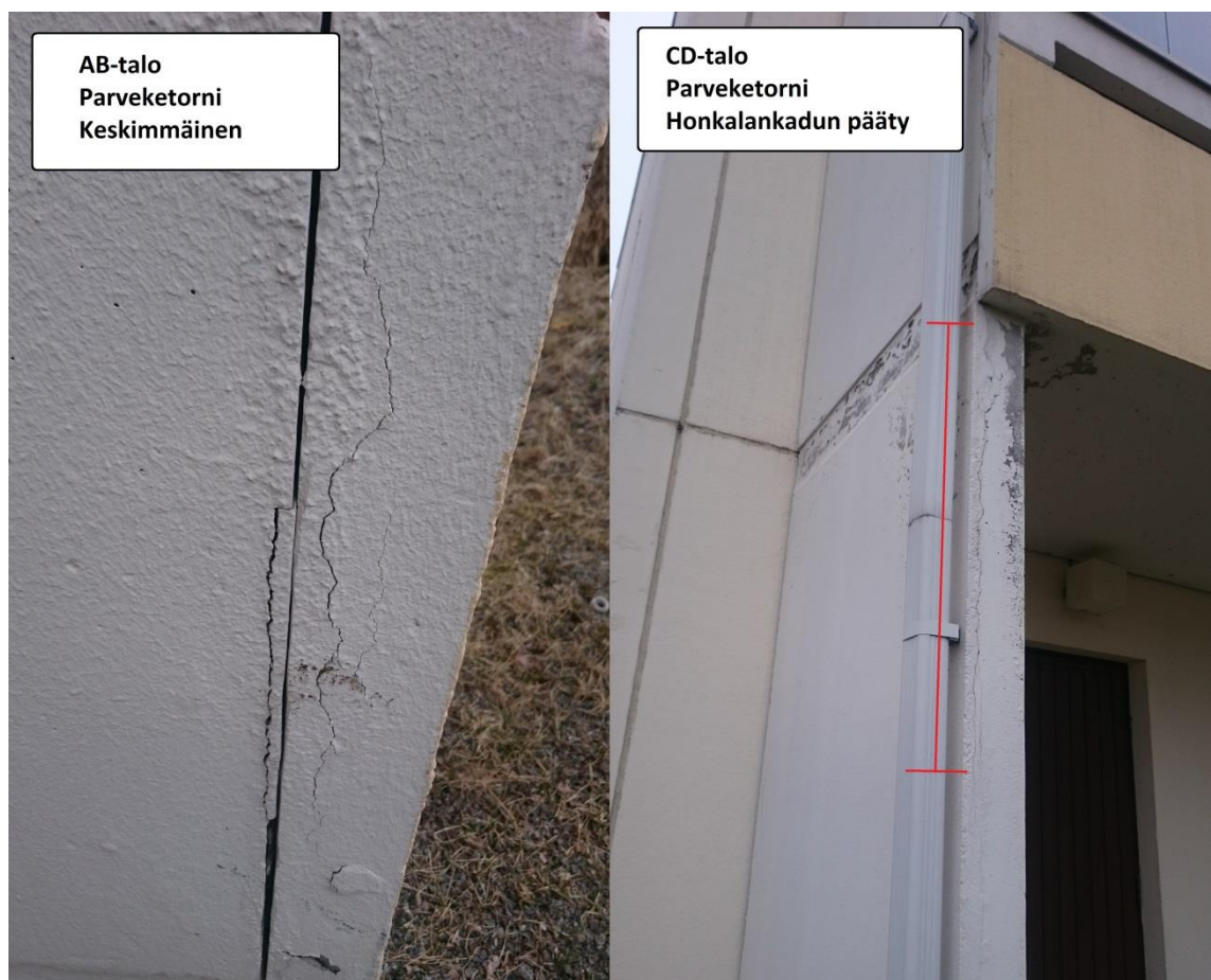
Kuva 9. Pitkiä pystysuuntaisia halkeamia parvekepielessä ja -kaiteessa
