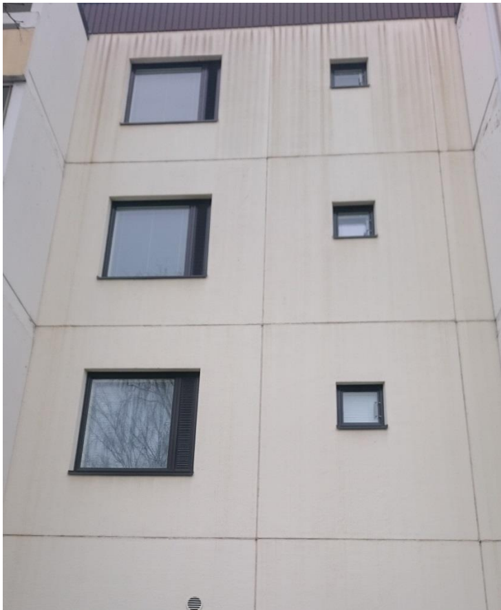
Kuva 7. Pellityksestä johtuvaa valumajälkeä CD-talon kaakkoissivulla
