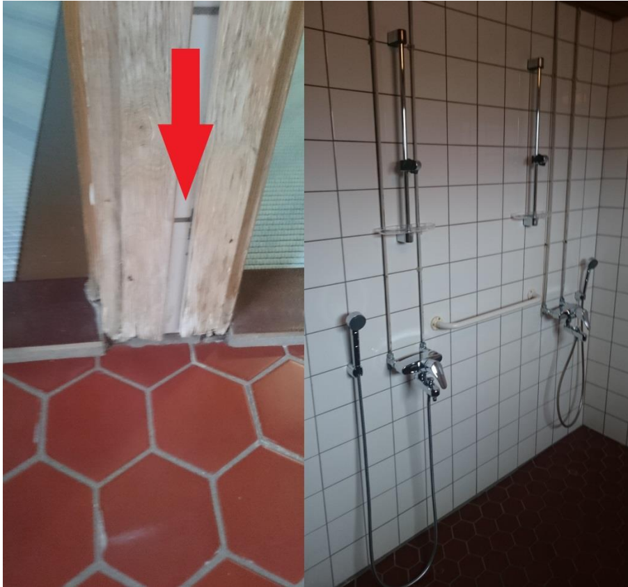
Kuva 16. AB-talon pukuhuoneen väliseinän alareuna ja saunan pesuhuone
