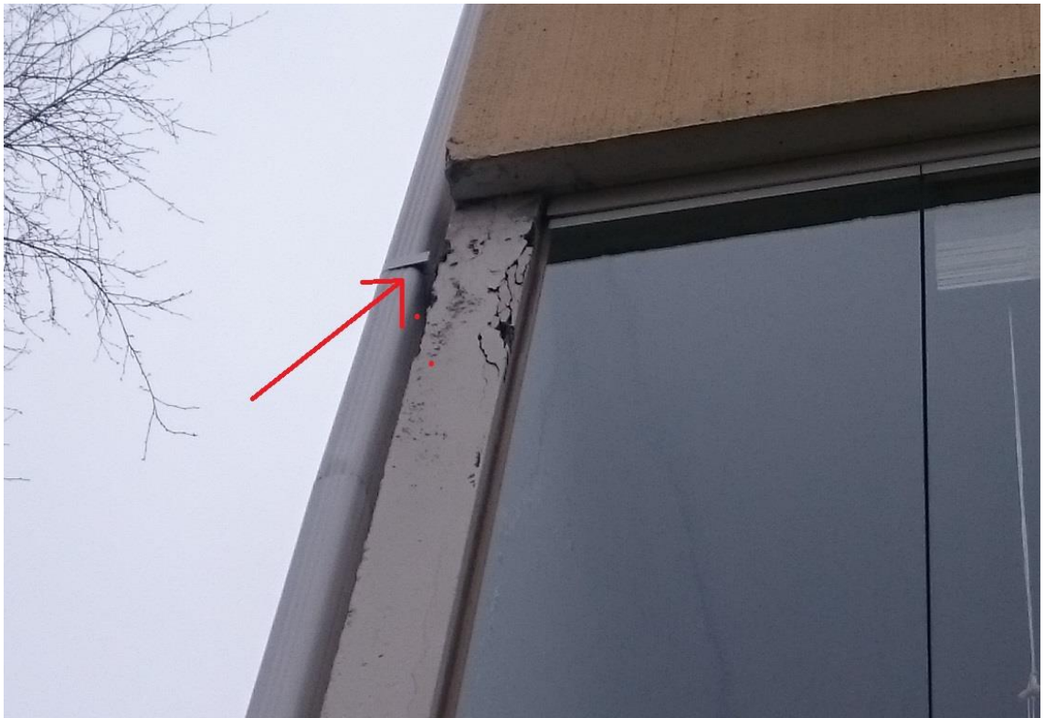
Kuva 10. Pitkälle edennyt vaurio parvekepielessä
