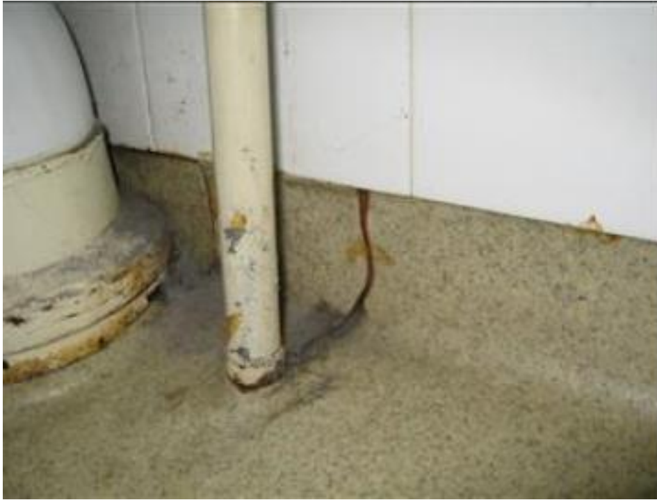
KUVA 11. Huonokuntoinen muovimaton sauma tai läpivienti saattaa sallia vuodon rakenteisiin. (Kuva: Hometalkoot.fi 2016)
