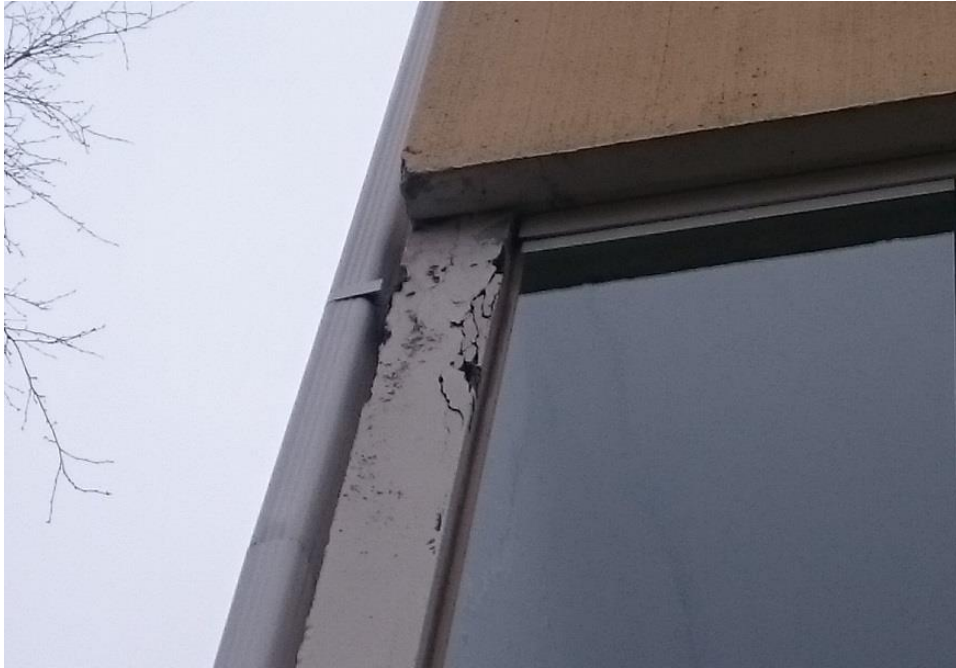
KUVA 8. Pakkasrapautuman aiheuttamaa betonipinnan säröilyä parvekepielen elementissä. (Kuva: Vili Teutari 2016)
