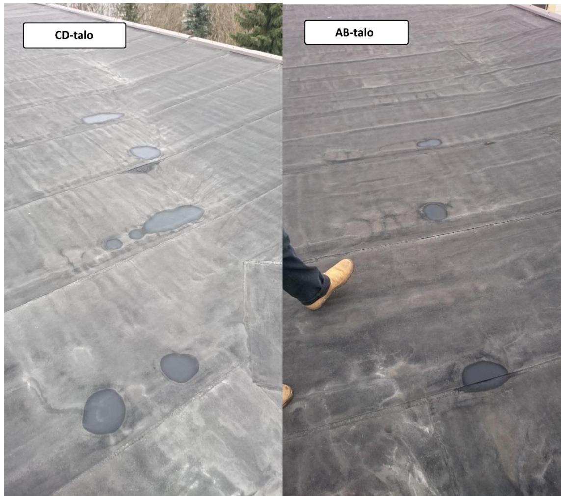
Kuva 14. Veden lammikoitumispaikkoja talojen katoilla
