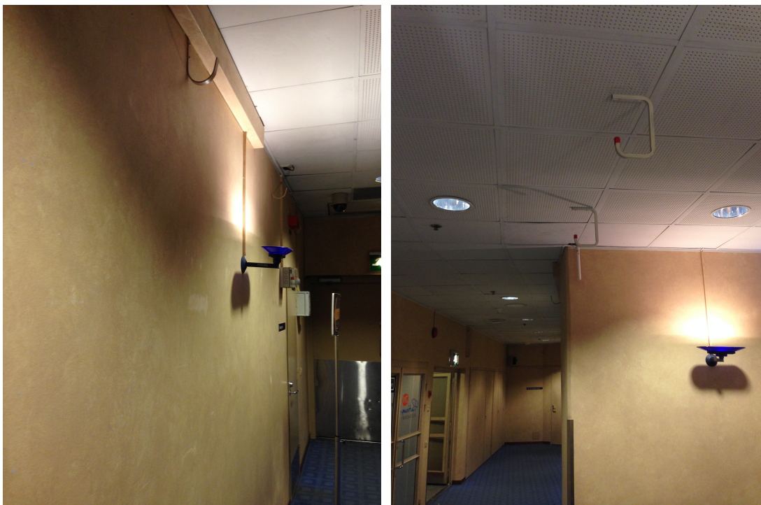
Kuva 6. ja 7. Kaapelikoukkureittiä Hartwall-arenalla.
