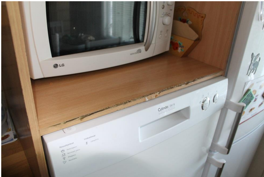
Kuva 40. Tason reuna on vaurioitunut.
