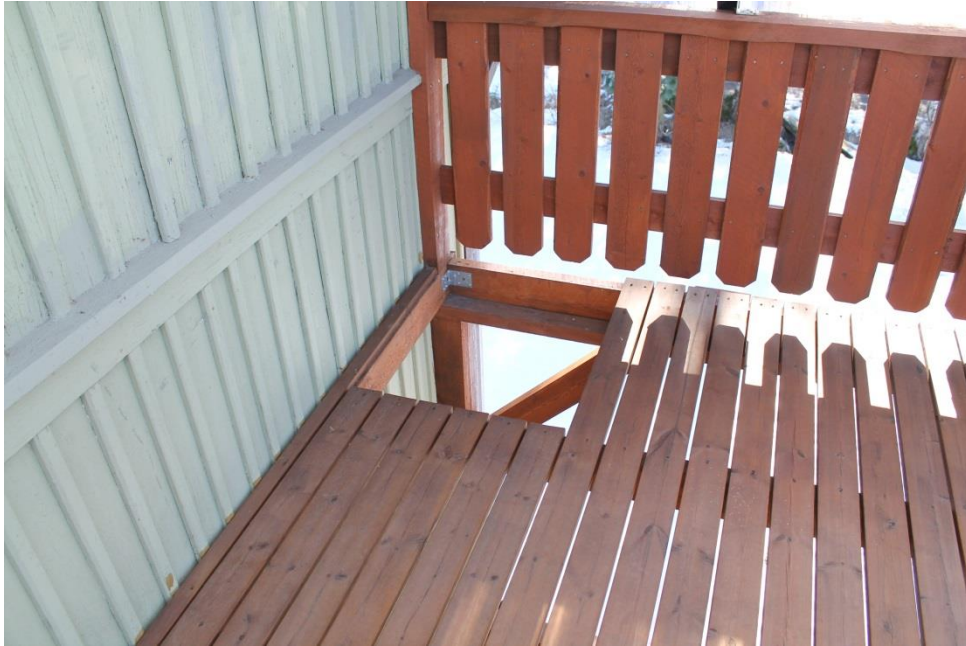
Kuva 27. Parvekkeen lattiassa on reikä.
