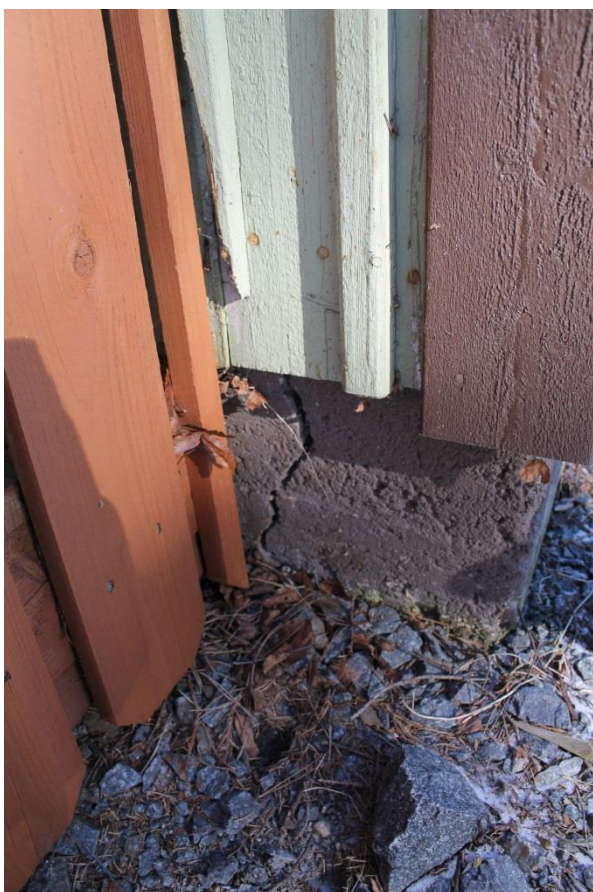
Kuva 5. Alkuperäisen osan perusmuurissa halkeama lounaisessa kulmassa.
