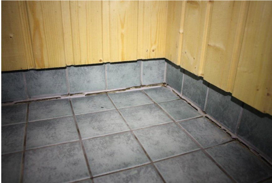
Kuva 38. Saunan ulkonurkan silikonit ovat revenneet.
