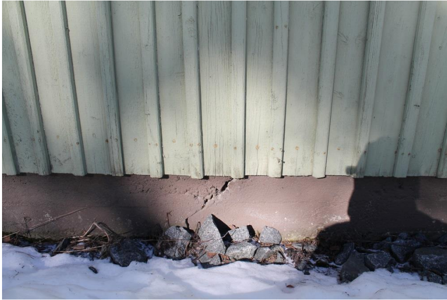
Kuva 6. Halkeama perusmuurissa eteläisellä sivulla.
