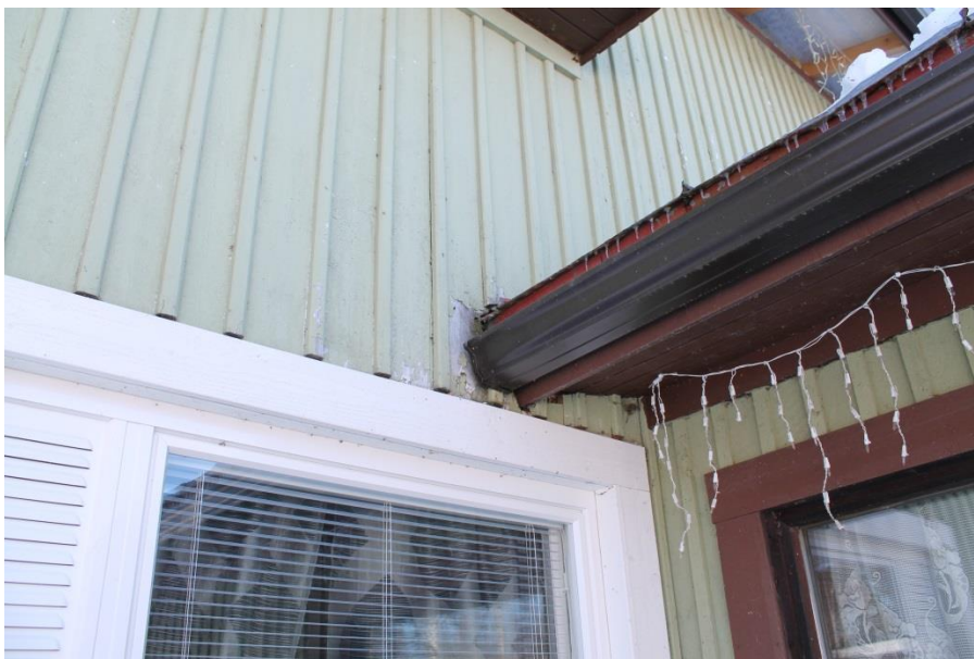
Kuva 20. Ulkoseinäverhous vaurioitunut pohjoispuolella.
