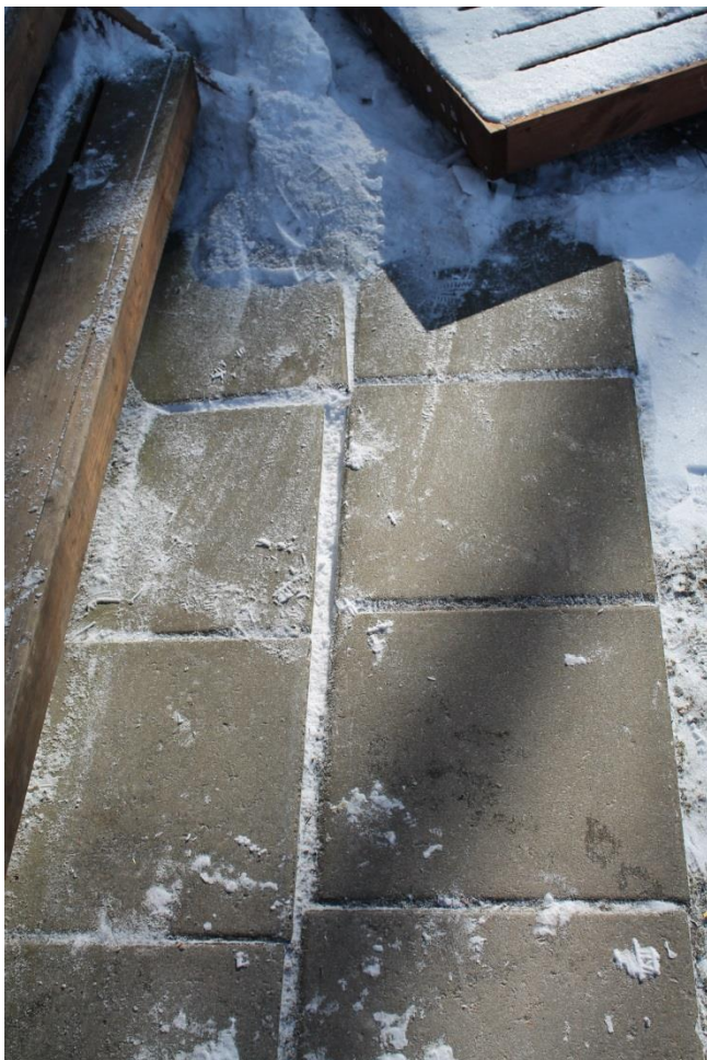
Kuva 3. Betonikivetykset ovat rakoilleet toisistaan.
