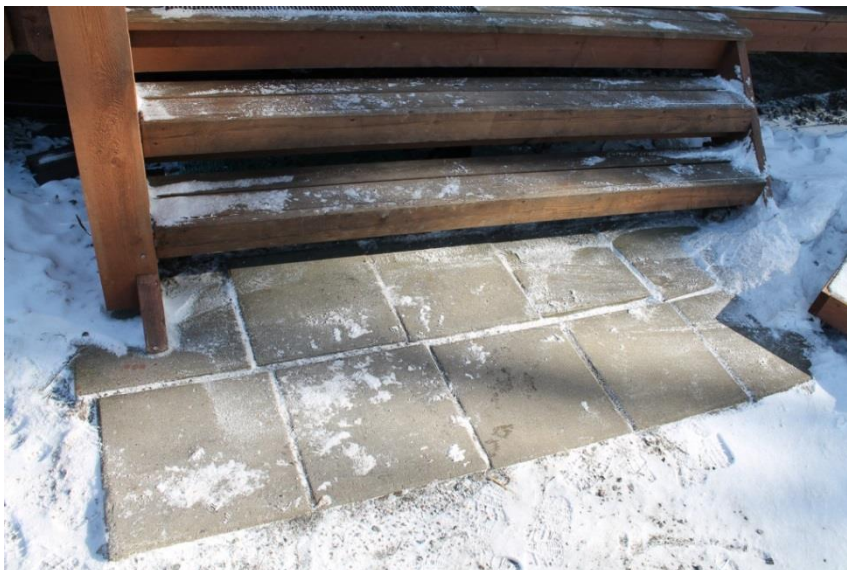
Kuva 2. Betonikivetys terassin rappusten edessä.
