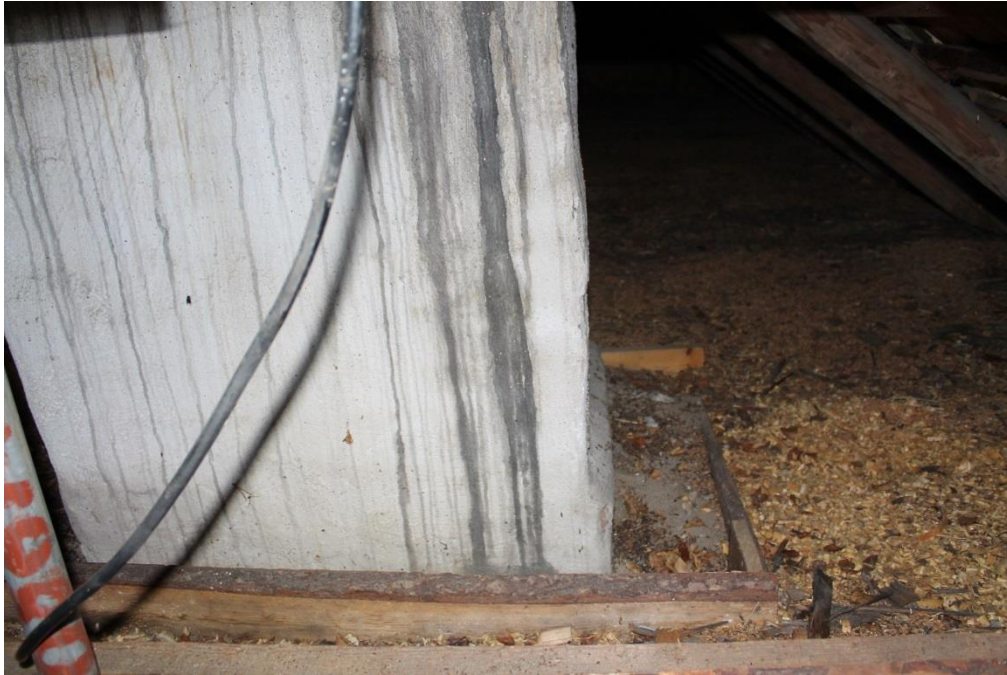
Kuva 30. Savupiipussa valumajälkiä ja savupiipun paloeristys.
