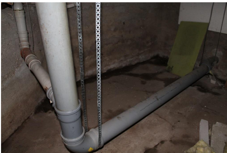
Kuva 12. Kellarin lattiassa kosteita alueita.
