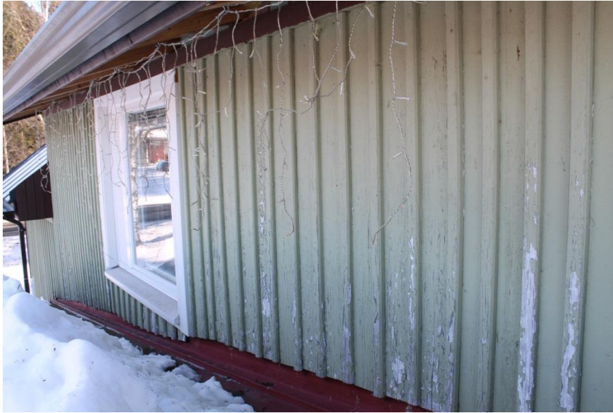
Kuva 19. Maalivaurioita ulkoverhouksessa alkuperäisen osan pohjoispuolella.
