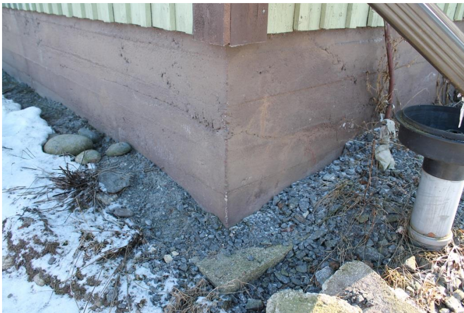
Kuva 4. Laajennusosan perusmuurissa pieni halkeama.
