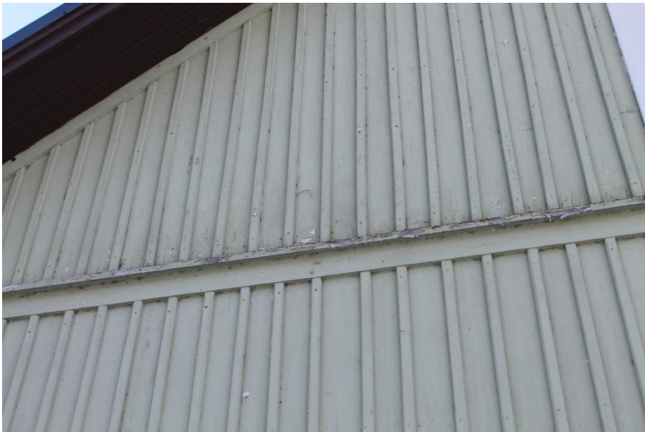
Kuva 18. Idän puoleisen päädyn maalivaurioita.
