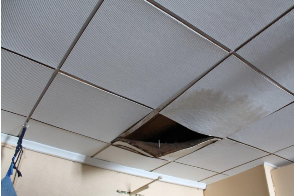
Kuva 36. Kattovuodon aiheuttamat vauriot sisäkatossa.
