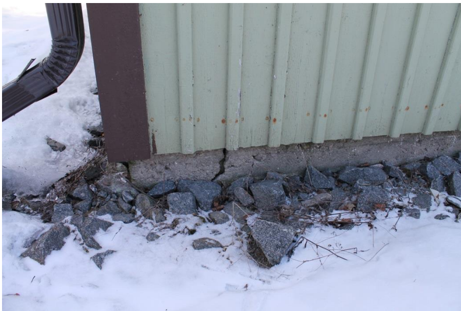
Kuva 7. Perusmuurin halkeama kaakkoisessa nurkassa.
