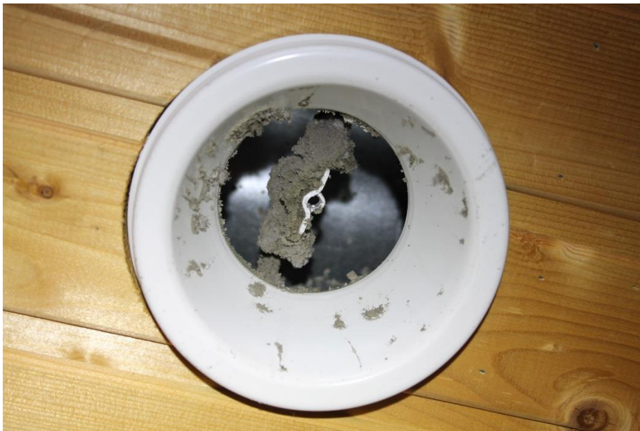
Kuva 41. Ilmanvaihtokanavat ovat pölyisiä.
