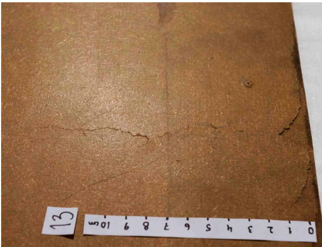
Kuva 11. Yksityiskohtakuva taustapuolelta kuitulevyn (levy 13) halkeamasta.
