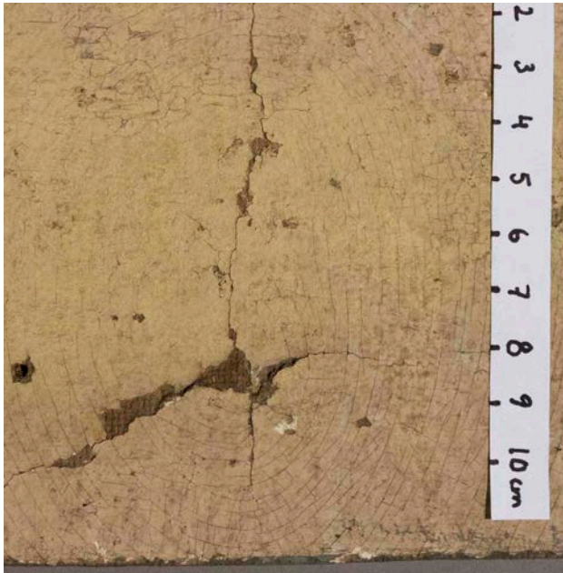
Kuva 18. Krakelyyrimuodostelma levyn halkeaman alueella (levy 13).
