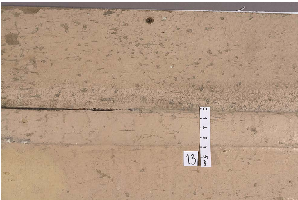
Kuva 16. Yksityiskohtakuva levyn 13 yläreunasta. Kuvassa nähdään muun muassa mahdollisen listan jättämiä jälkiä ja sen reunoille kertynyttä likaa.
