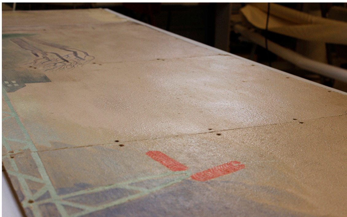
Kuva 35. Maalipinnan epätasainen kiilto.
