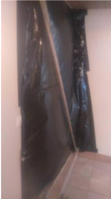
Kuva 2. Kellari on eristetty muusta asuintilasta sulkemalla portaikko tiiviillä muovilla.
