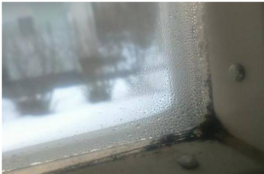
Kuva 1. Tiivistynyttä kosteutta kylmässä ikkunalasissa.
