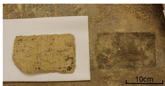
Kuva 29. Iso tukipaikka on poistettu
