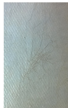
Kuva 20. ”Corn ear crack” muistuttava krakelyyri
