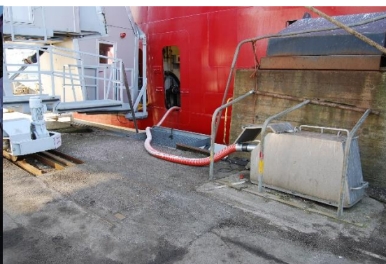
Bild 4, Grå- och svartvattenkoppling i plåtskåp
