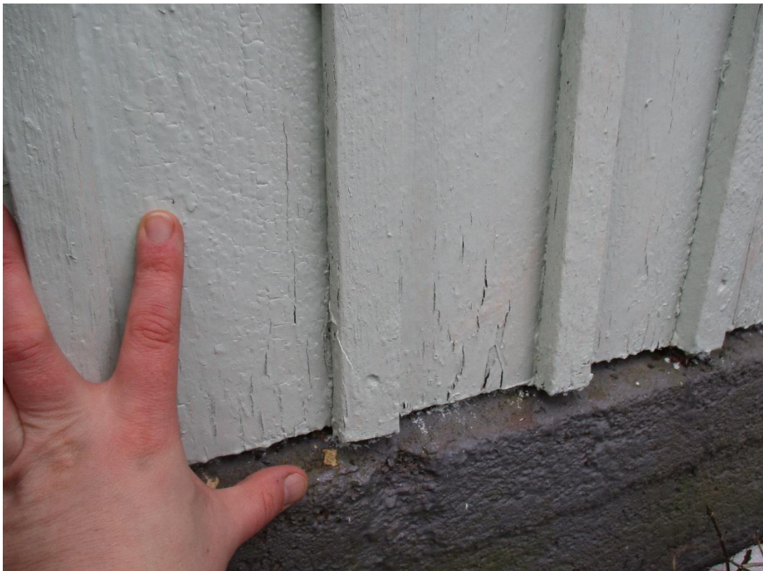
Kuva 18 Laudoituksen alapää on korjattavissa vaakasuuntaisella listoituksella.
