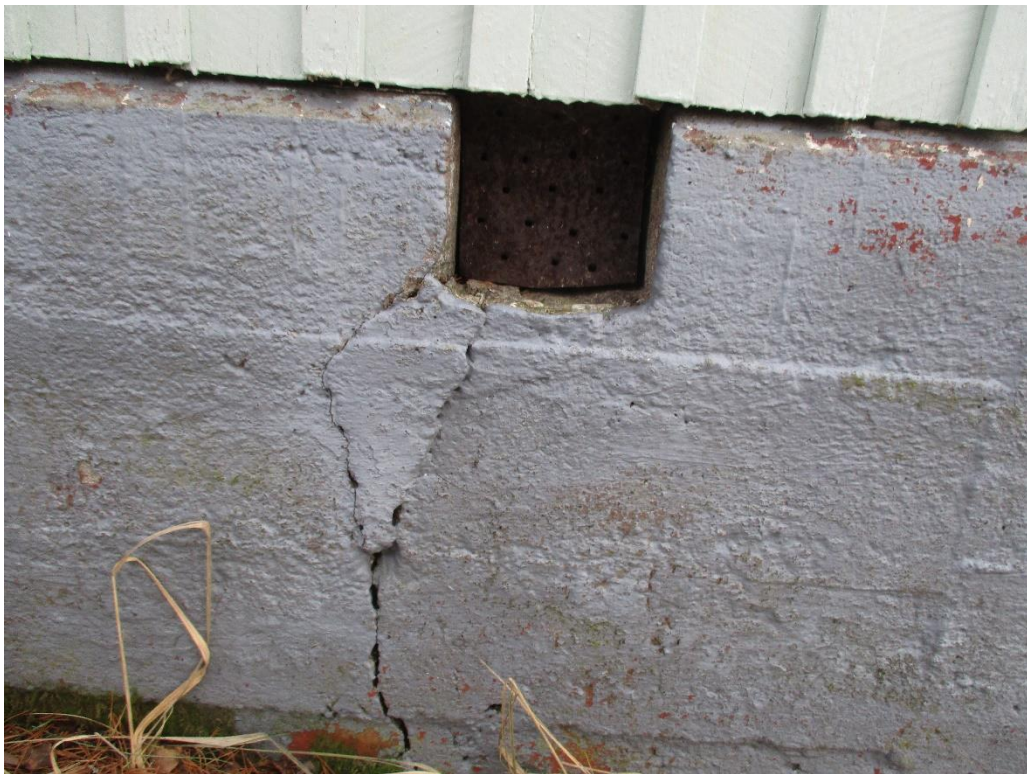
Kuva 11 Epätasaisesta painumisesta johtuva halkeama takapihan puolella.
