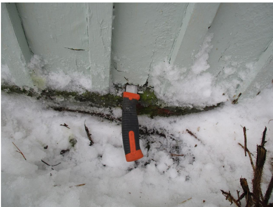
Kuva 14 Alimmassa hirsikerrassa on lähes kauttaaltaan lahovaurioita.
