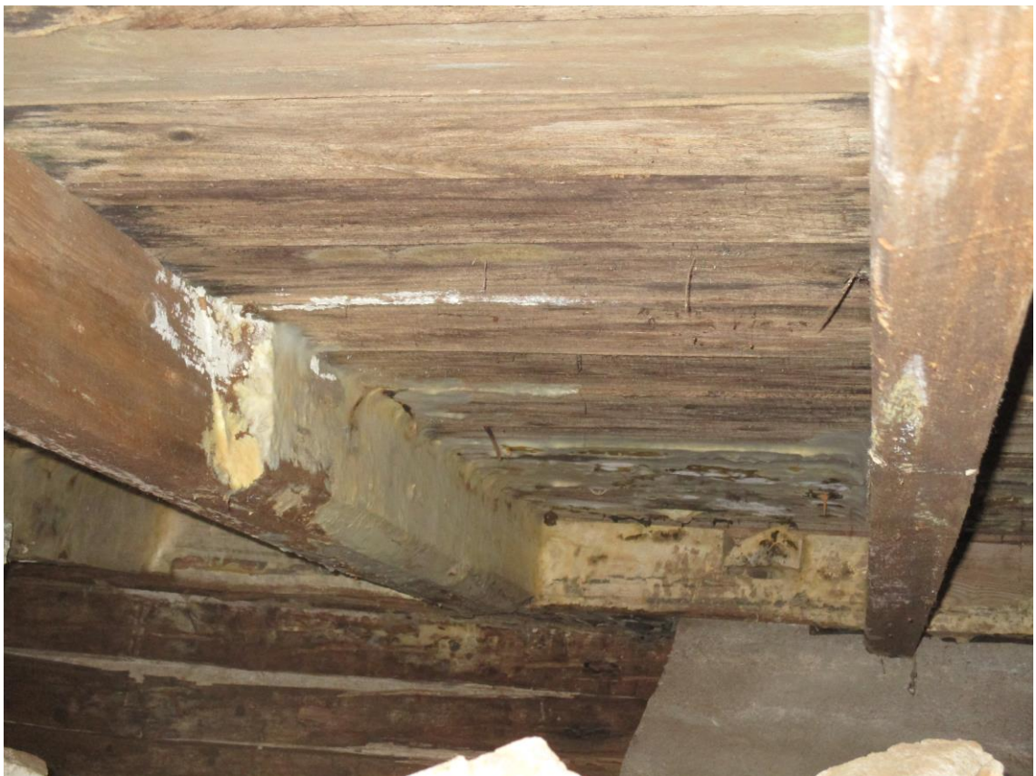
Kuva 2 Kohteen alapohjasta löytyi mittava lahottajasienivaurio.
