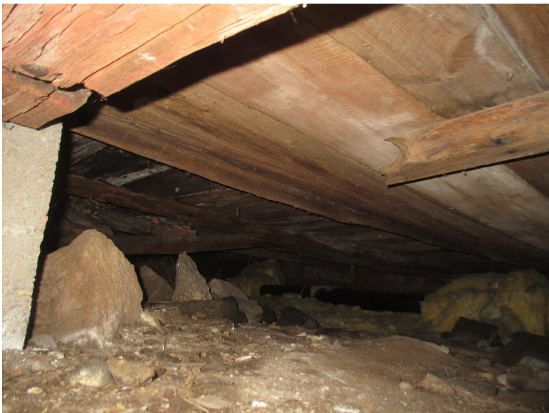
Kuva 25 Pohjoispäädystä rakenteita on osittain romahtanut.
