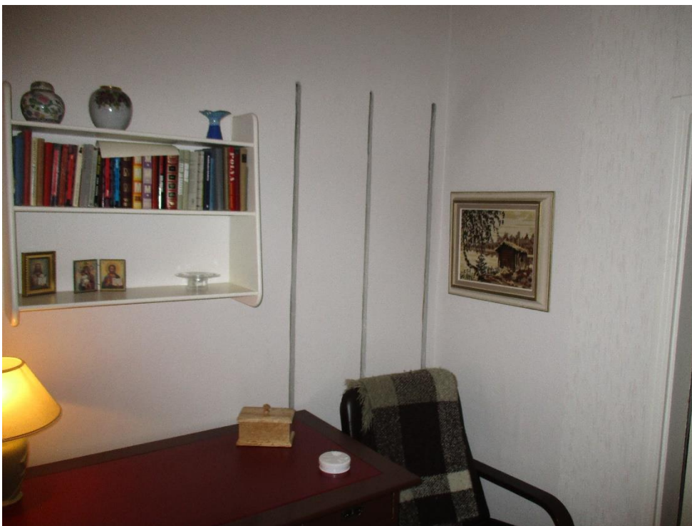
Kuva 39 Patterihormistoja on alakerran lisäksi myös yläkerrassa.
