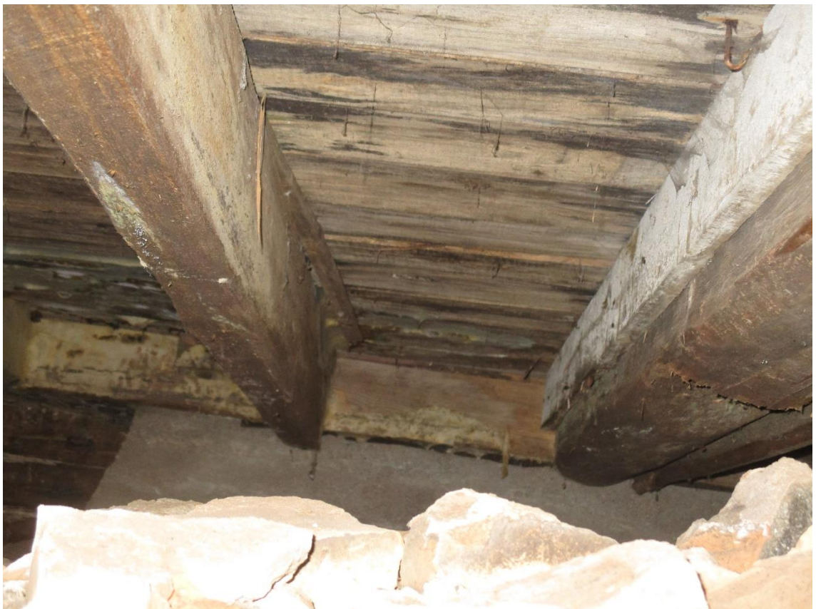
Kuva 19 Lahottajasienivaurio on lahottanut rakenteita niin, että kantavia rakenteita on osittain jo pettänyt tai murtunut.
