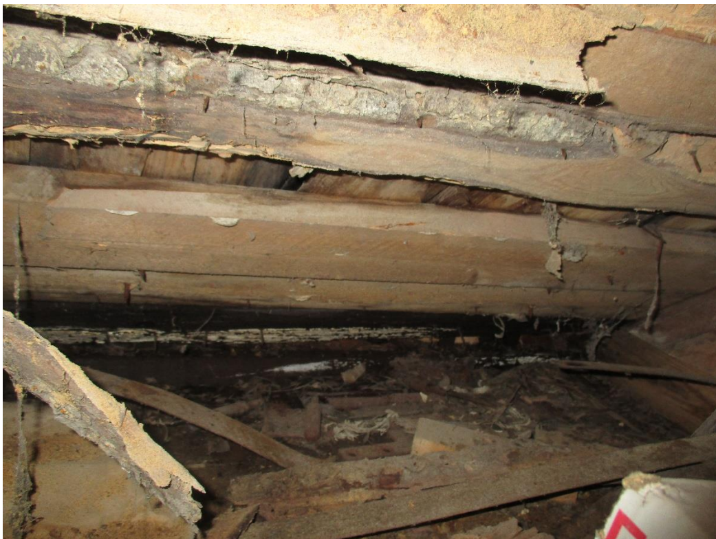
Kuva 30 Idän puoleisen kattolapteen räystäskoteloinnin korjataan tulevaisuudessa.
