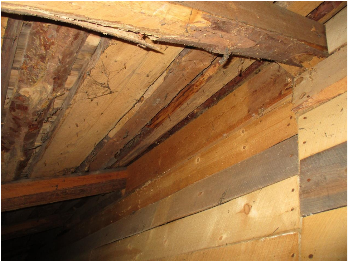
Kuva 31 Lämmöneristeen sekä vesikatteen aluslaudoituksen välissä tulisi olla avoin tuuletusrako sivuvintiltä yläkolmioon. Koska rakoa ei ole, niin kyseessä on riskirakenne.
