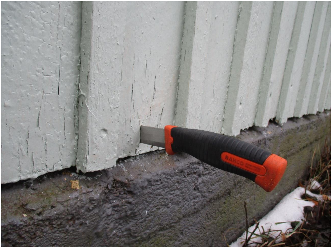
Kuva 15 Hirren ulkopinnasta vain 2..3 senttiä on lahonnut tässä kohdassa.
