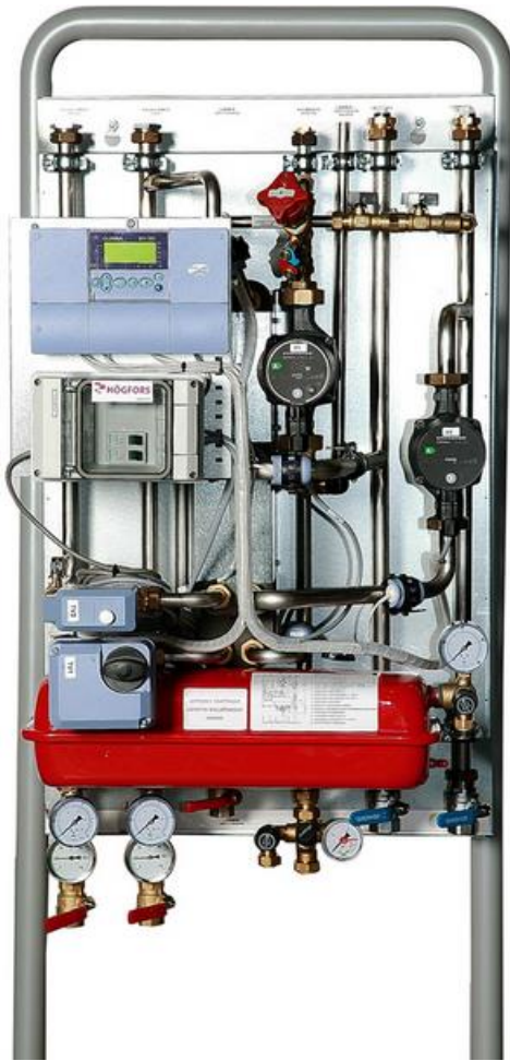
Kuva 5. Omakotitalon kaukolämmön alajakokeskus [7].
