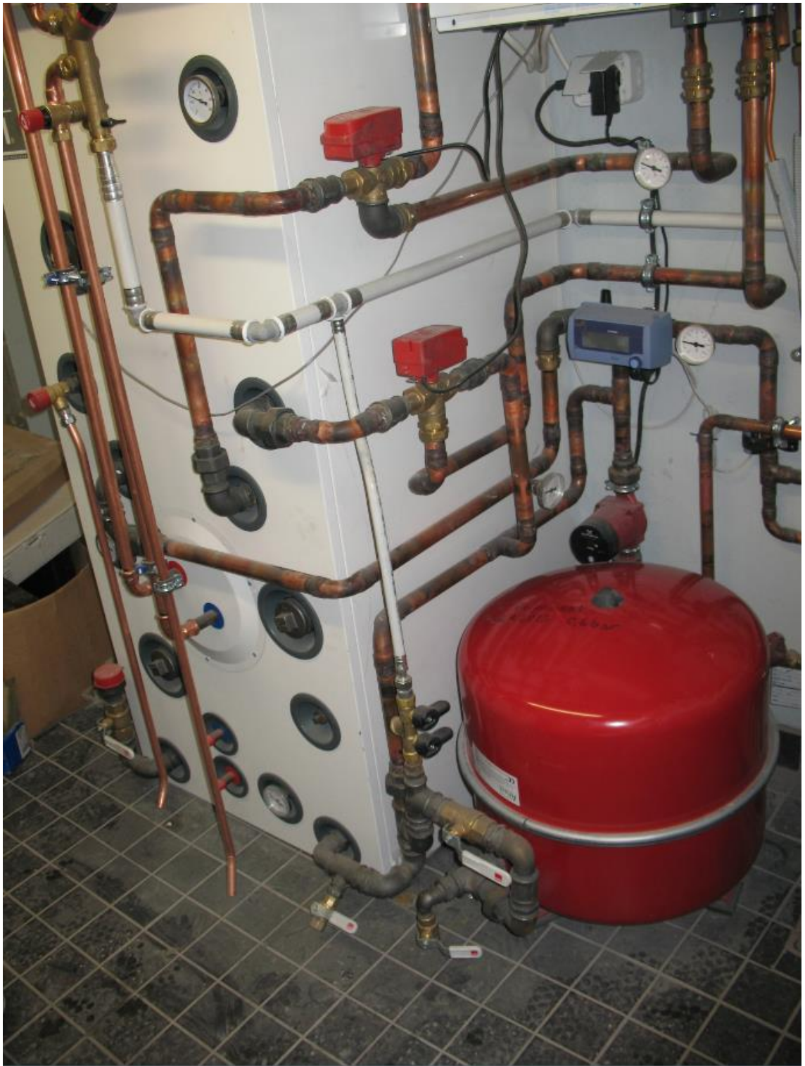
Kuva 14. Kohteen lämmitysjärjestelmä teknisessä tilassa, vaihtoventtiilit ja lämmönsäädin
