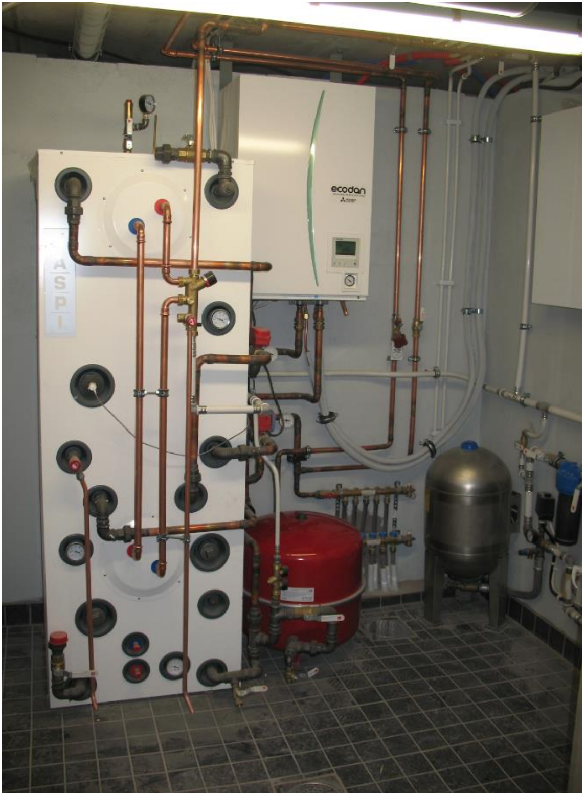
Kuva 13. Kohteen lämmitysjärjestelmä teknisessä tilassa, takan kytkentä toteuttamatta
