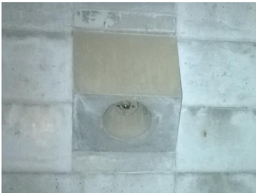
KUVA 4 Käynnistyspoltin (Andritz Oy, 2016)
