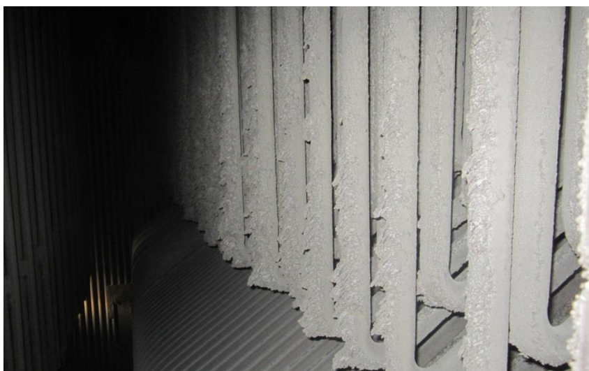
KUVA 29 Kerrostumaa tulistimessa (Andritz Oy, 2016)
