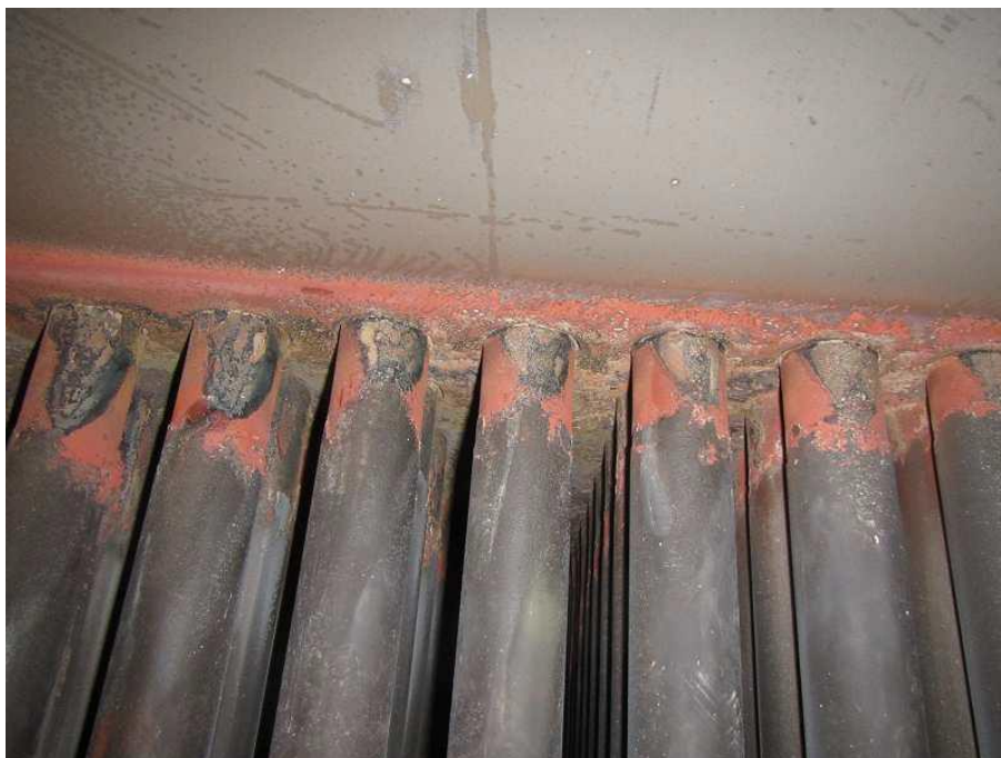
KUVA 30 Korroosiota savukaasuesilämmittimen palamisilman kylmässä päädyssä (Andritz Oy, 2016)
