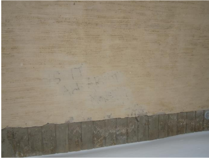
Kuva 7. Esikoulun päädyn kulunut rappaus.
