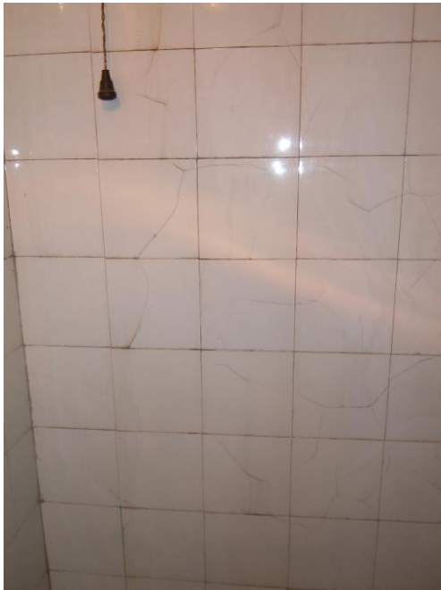
Kuva 23. Kellarin suihkutilojen halkeilleet seinälaatat.
