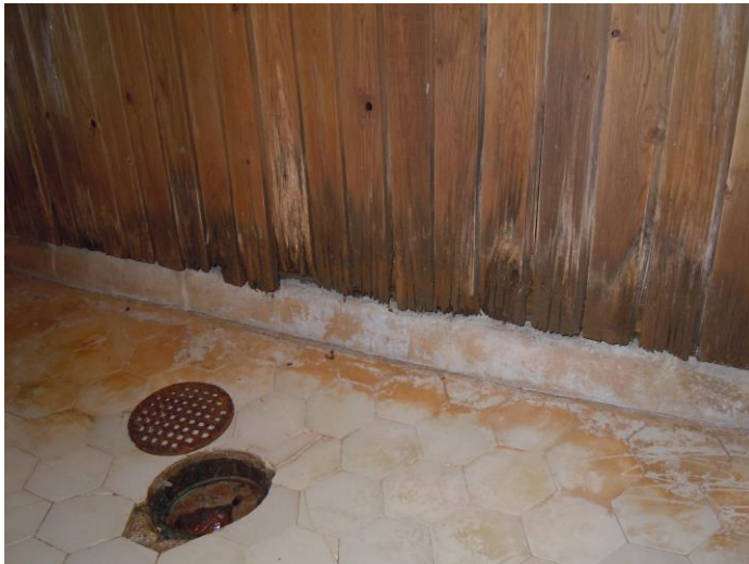
Kuva 20. Kellarin pesuhuoneen kulunut lattia ja kastuneet seinäpaneelit.
