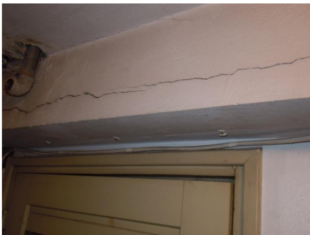
Kuva 22. Kellarin halkeillut palkkirakenne.
