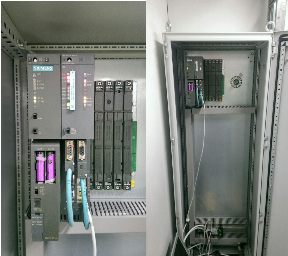
KUVA Kuvassa oikealla nähdään päälogiikkakortit ja vasemmalla yleiskuva kaapista.
