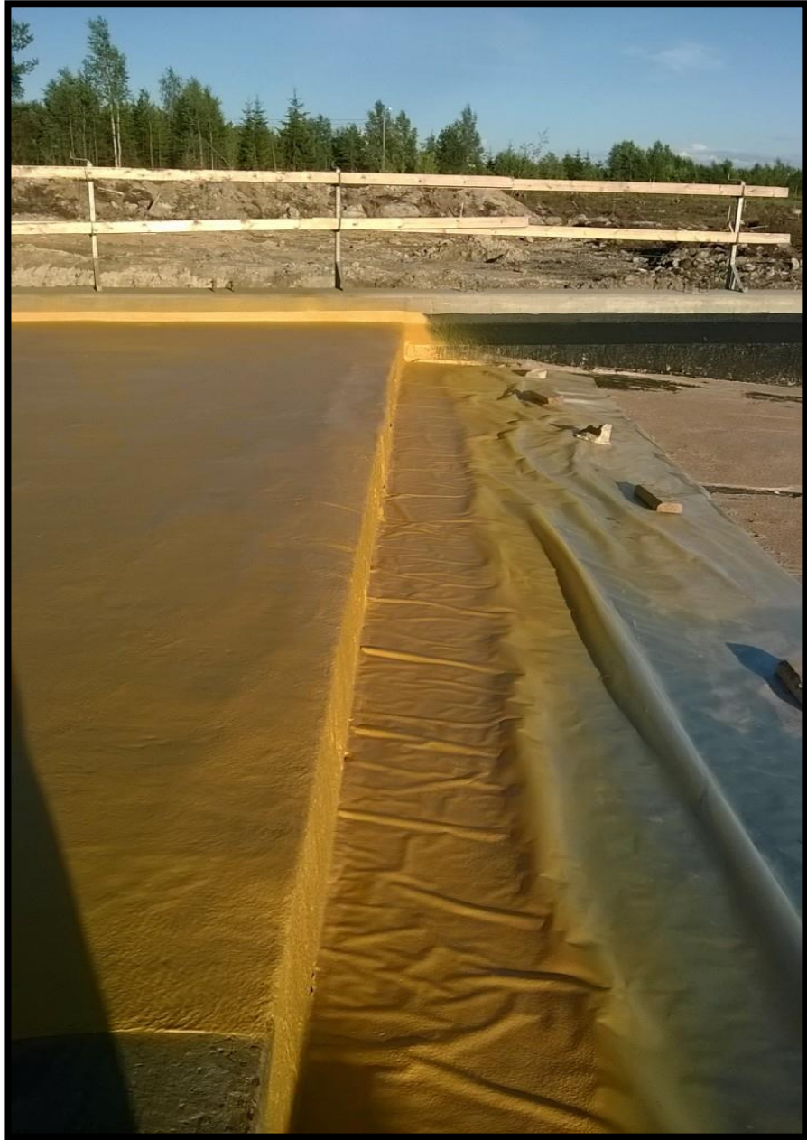
Kuva 7. Erotuskaista kannen ja siirtymälaatan yhtymäkohdassa
