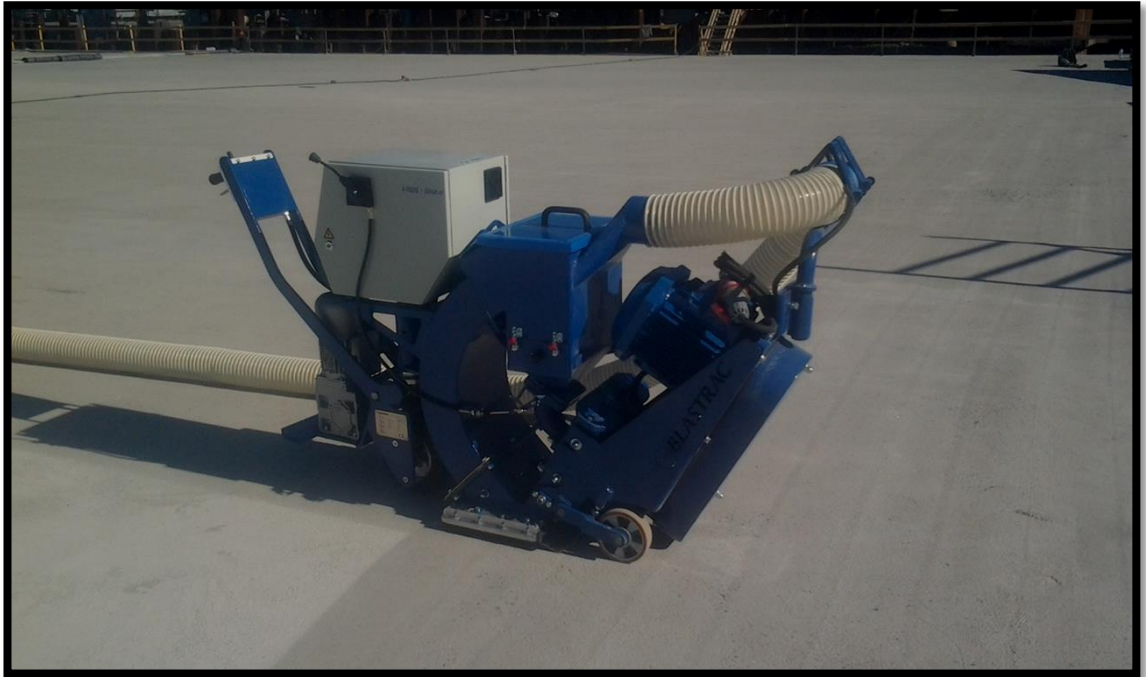
Kuva 19. Sinkopuhdistuslaitteen oikealla puolella kertaalleen ylitettyä pintaa ja vasemalla puolella karhentamatonta pintaa. Lähde: Alatalon rakennuspalvelut Arp Oy.
