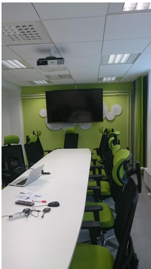
KUVA 22. Näyttö ja projektori asennettuna (Ruotsalainen, 2015-02-24.)
