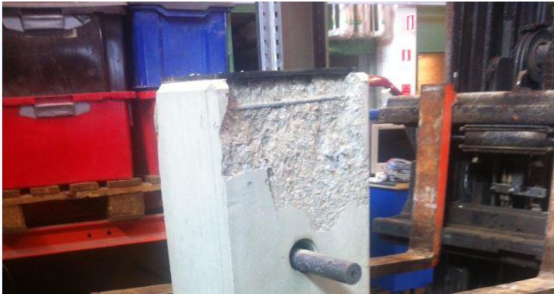
Kuva 16: Pilarin pään halkeaminen, kun hakarautoitus ei ole riittävä. (Sakari Lahti 2012)
