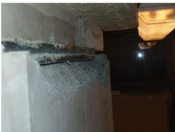
Kuva 5: Kuormituksessa laajentunut laakeri ja lohjennut betoni. (RVP-V-BE-21)
