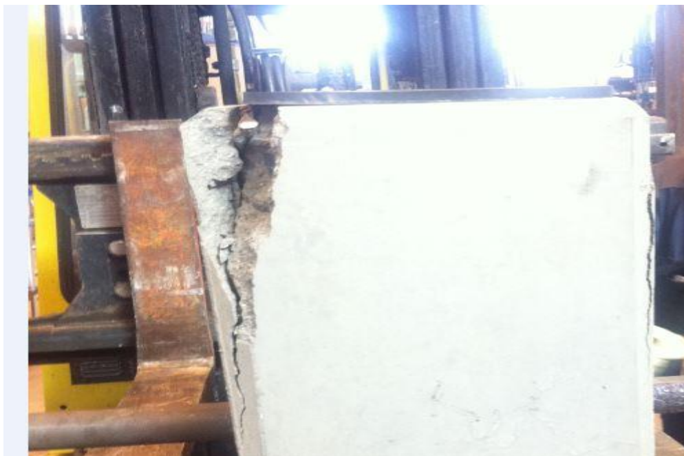
Kuva 15: Pilarin suojabetonin lohkeama (Sakari Lahti 2012)
