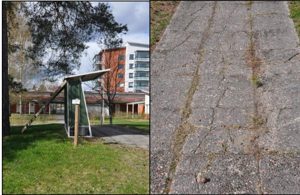
Kuva 8. Tupakointialue ja halkeillut betonilaatoitus eivät tue ajatusta vanhusten hyvinvointia kohentavasta piha-alueesta. (Noora Heikkonen toukokuu 2014.)
