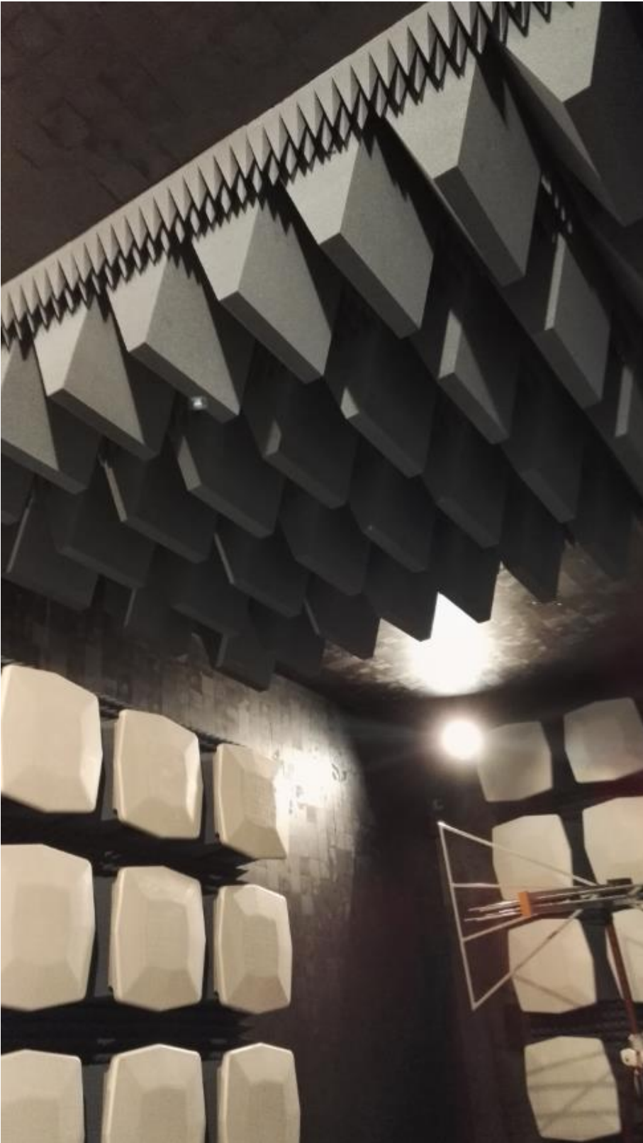
Kuva 17. Mittakammioon asennetut pyramidiset vaimennukset katossa
