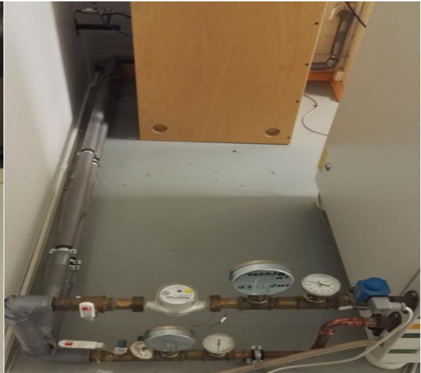
Kuva 22. Shokkitestikaappi Vötschin jäähdytys toteutettu vesijohtovedellä
