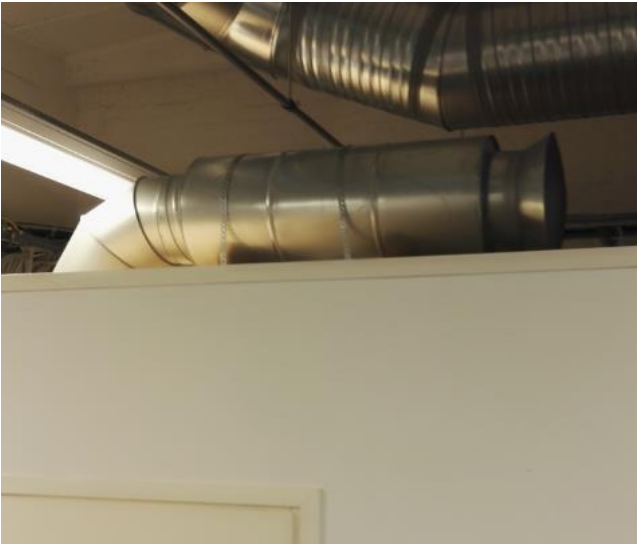
Kuva 21. Ilmanvaihto äänieristetyssä huoneessa
