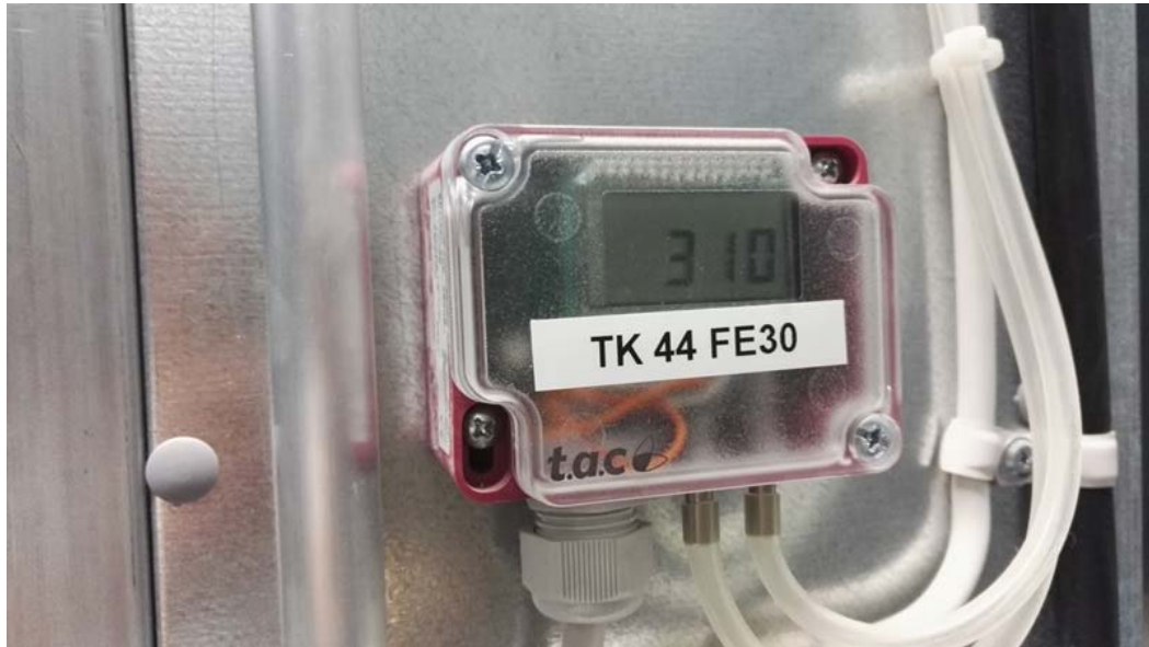
KUVA 2. TK44:n puhaltimen paine-erolähetin
