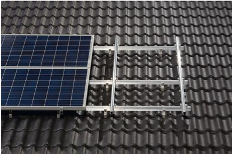
Bild 18. Solpaneler med dubbla metallskenor. (paradisenergi.se 2014)
